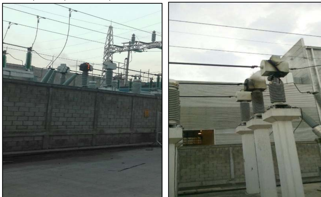
Fig. 4.22 Daños en TC'S de subestación GEP 115 KV
