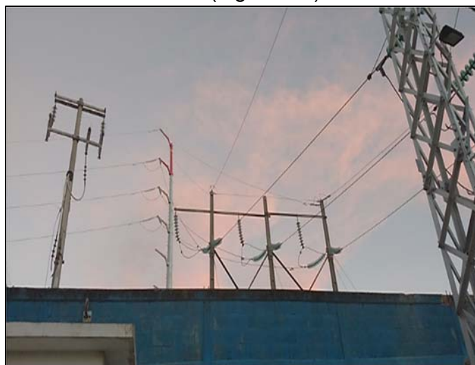
Fig. 4.3 Acometida alta tensión 115 KV, Planta GEP
