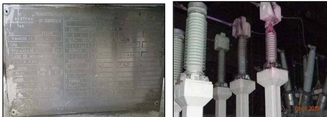
Fig. 3.16 (a) Placa de datos TC'S caso de estudio (b) TC'S fallados por falla del aislamiento
