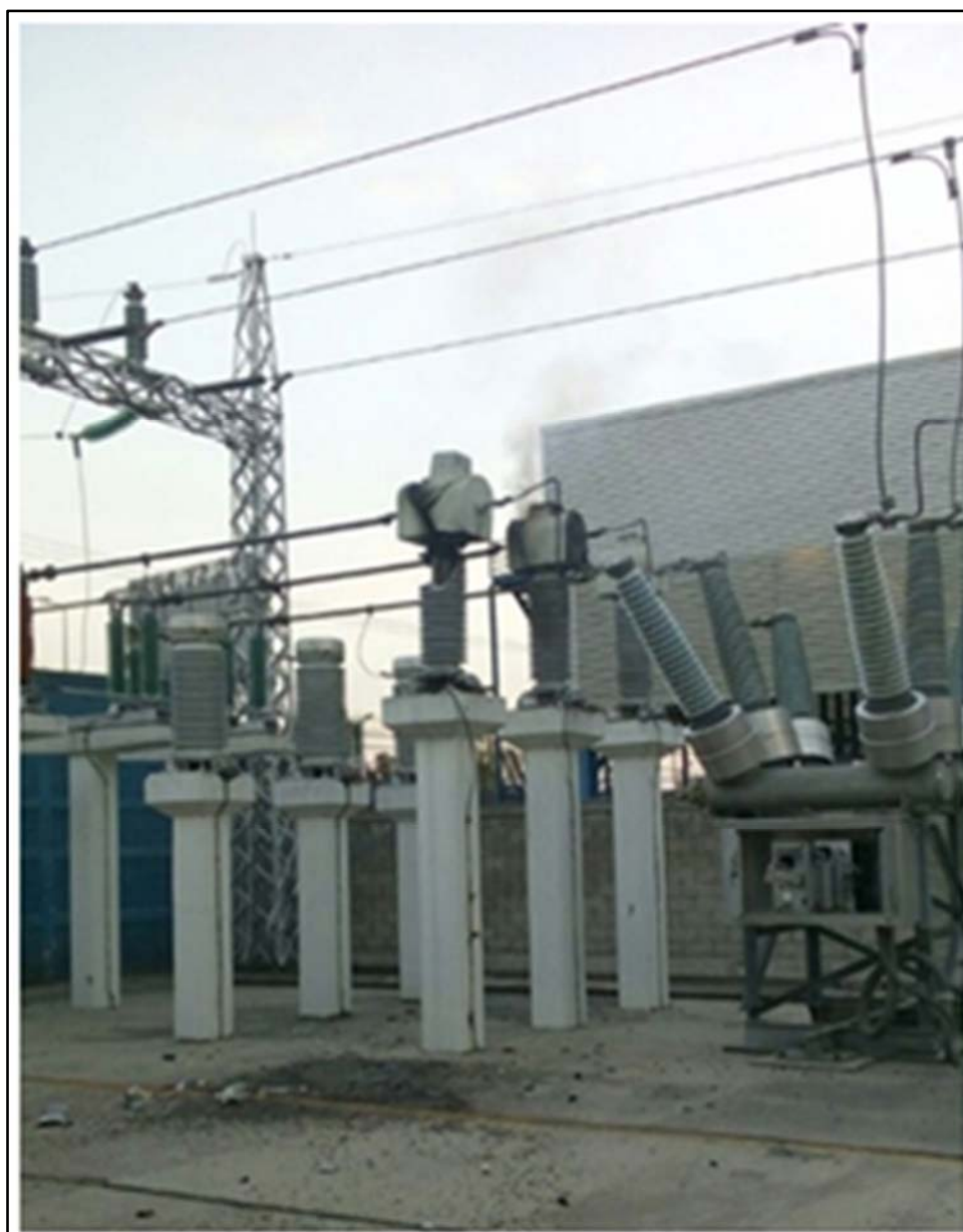
Fig. 1.2 TC'S fallados por falla del aislamiento.
