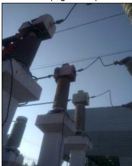
Fig. 4.5 Transformadores de Corriente Subestación GEP
