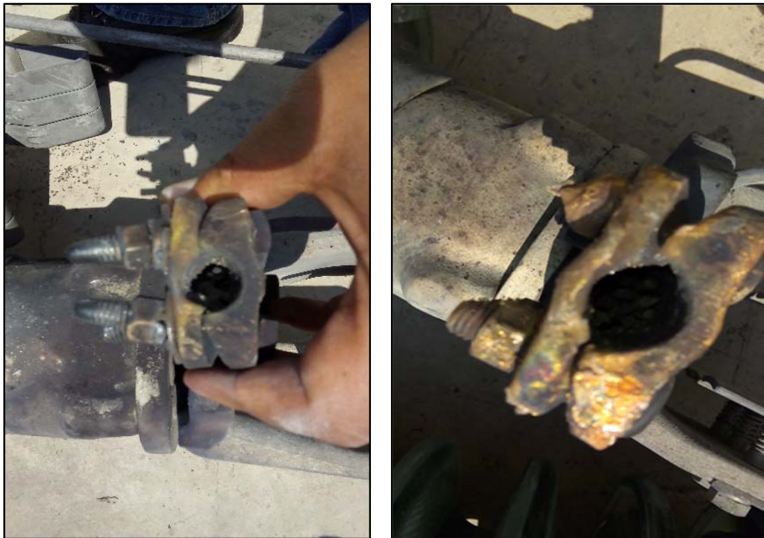
Fig. 4.23 Daño en Conectores de tercia Subestación GEP
