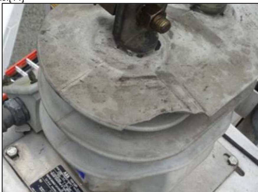
Fig. 3.8 Transformador de corriente en operación con daños en el aislamiento
