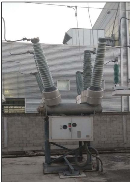
Fig. 4.6 Interruptor Alta tensión SF6 Subestación GEP
