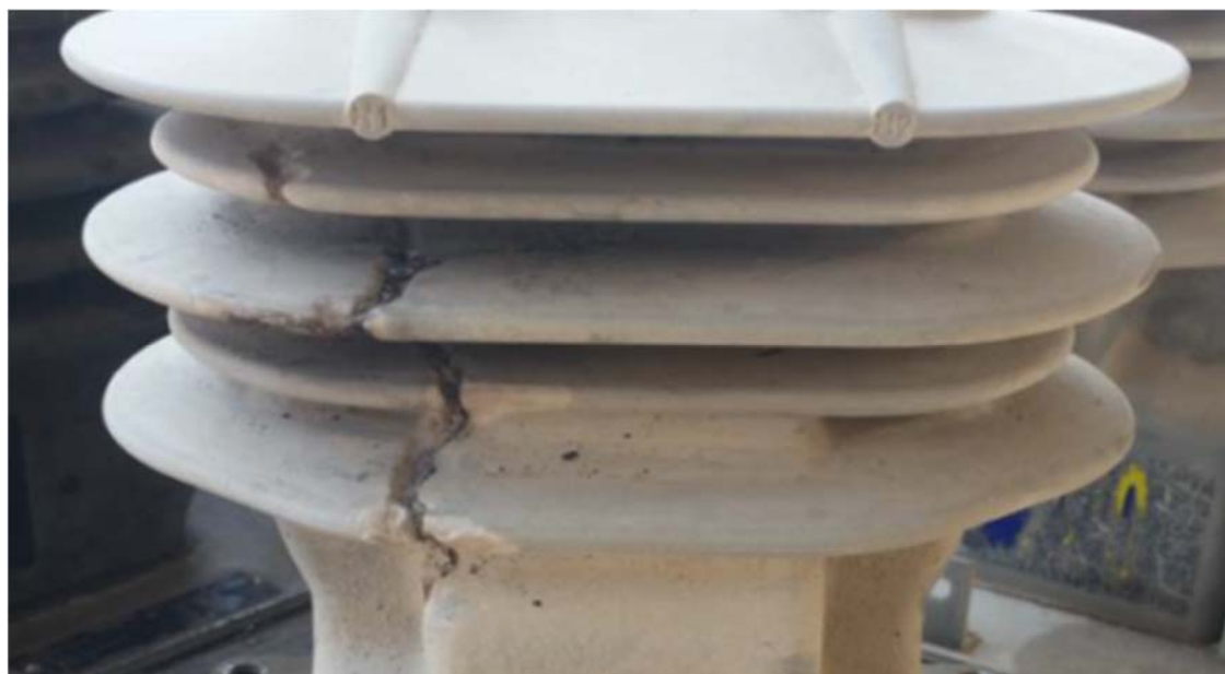
Fig. 3.6 Aislamiento deteriorado de transformador de corriente para media tensión
