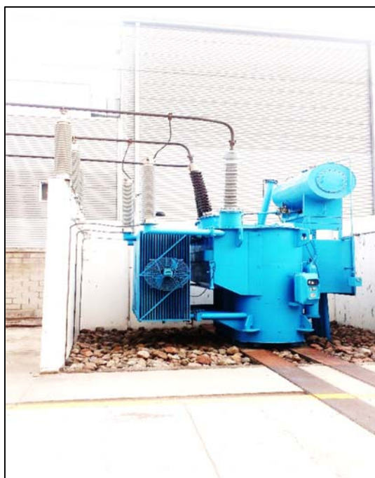
Fig. 4.7 Transformador 115 KV/13.2 KV subestación GEP
