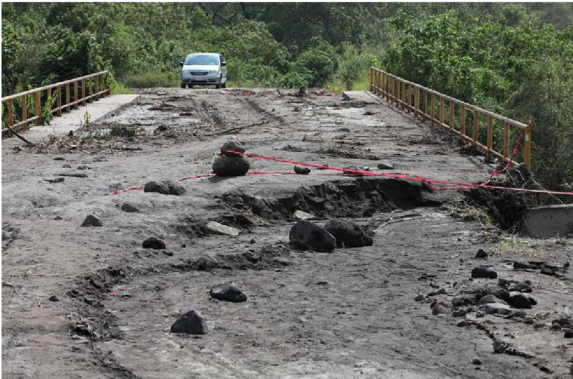
Figura 11: Daños ocasionados en octubre de 2015 por un lahar desencadenado por intensas precipitaciones en el Volcán de Colima (fotografía tomada de http://www.manzanillo.tv/1015/25/patricia-comala.html citada en Martínez, 2019).
