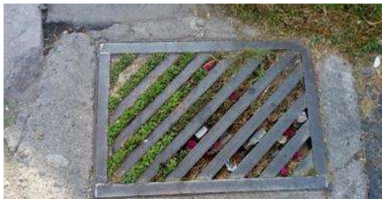
Fotografía 3.- Alcantarilla tapada por tierra y basura
