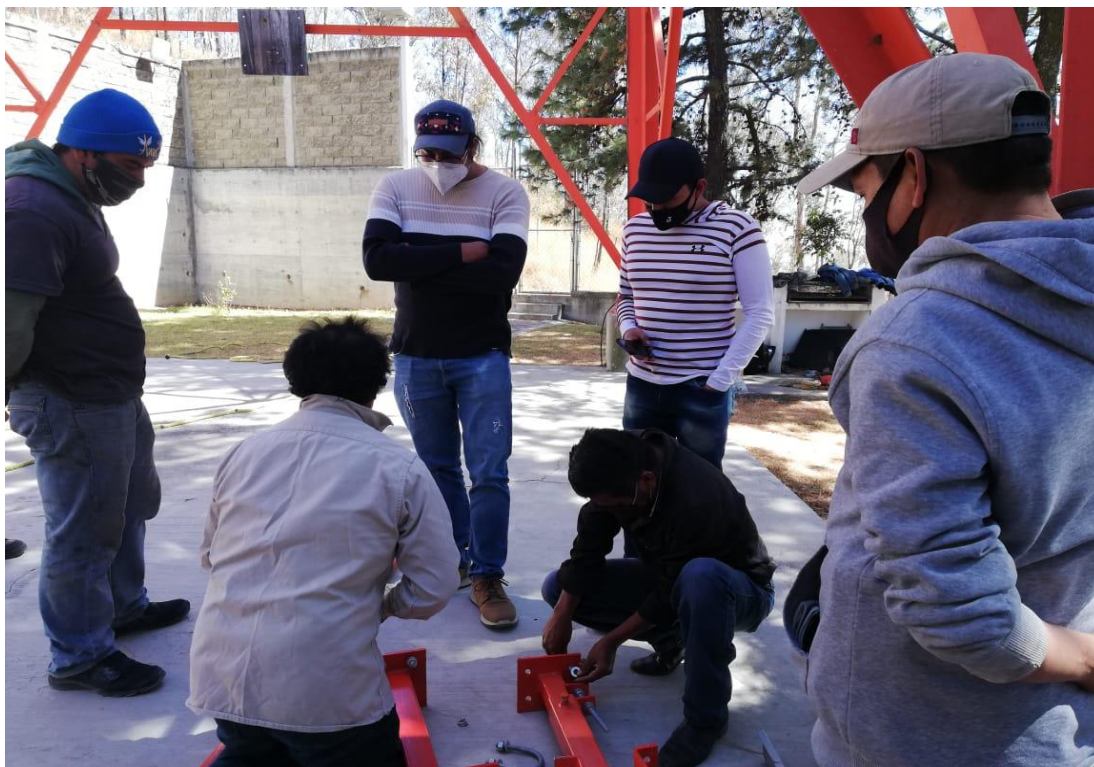
Figura 10 Instalación de la Antena por parte de Cholollan y Zacatepec Radio
