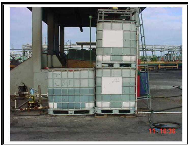
EQUIPO DE DOSIFICACION
