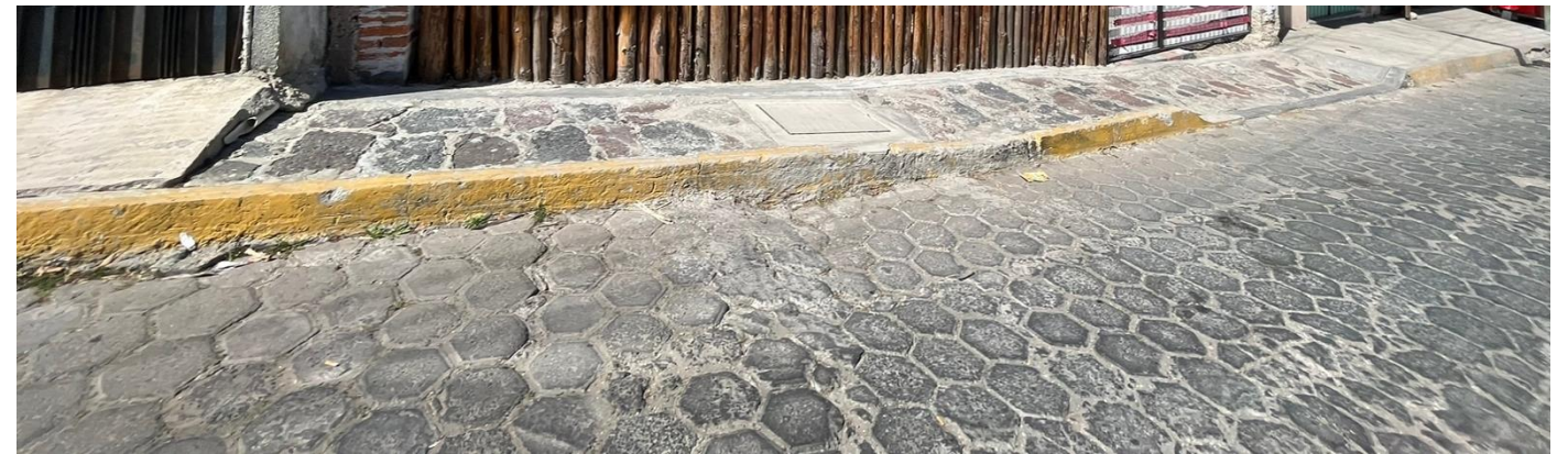
Imagen 12. Rojas, J. (2023). Estado de las banquetas en San Salvador El Seco [Fotografía]. San salvador el Seco, Puebla, México.
