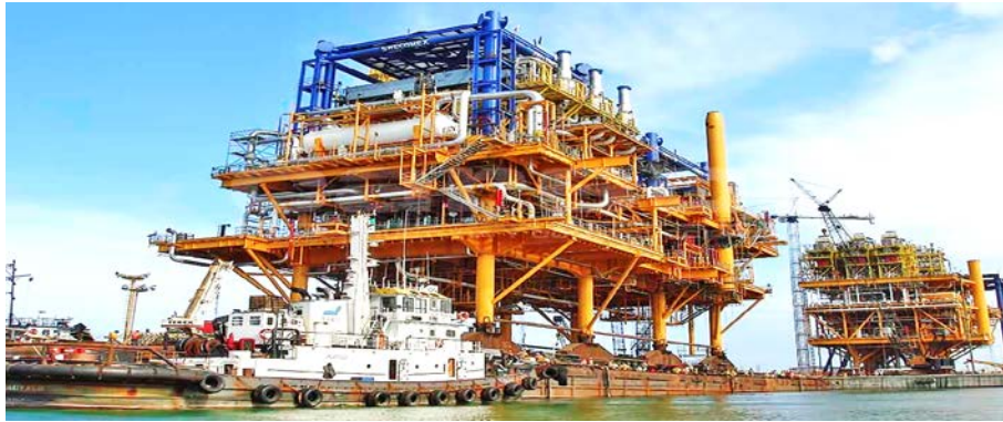
Figura 10. Plataforma de rebombeo.
