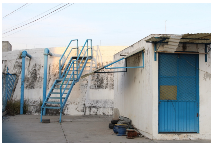
Riesgo en el agua potable que llega a la UH, ya que el sistema de abastecimiento de agua no cuenta con el tratamiento necesario y se encuentra expuesto, Vega, Suck, 2024.
