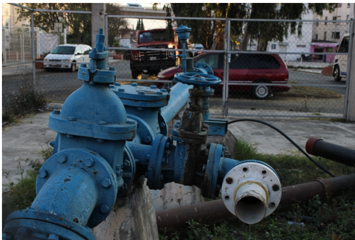
Fugas de agua en sistema de agua, Vega Suck, 2024.
