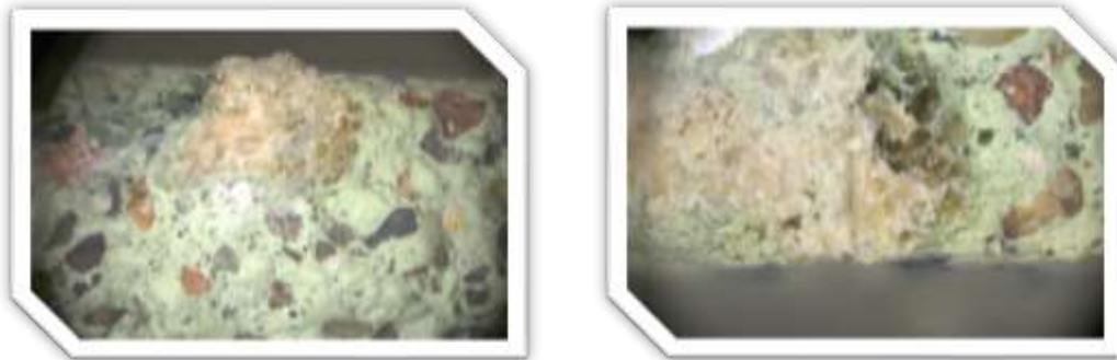
Ilustración 53. Interior del adoquín en la zona de la presencia de burbujas
