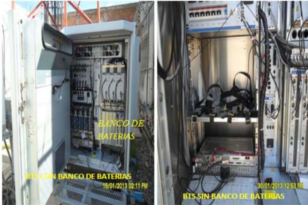
Figura 3.30 BTS sin banco de baterias.
