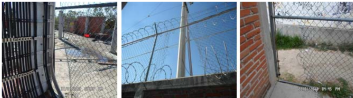
Figura 3.31 Daños en la infraestructura del sitio.
