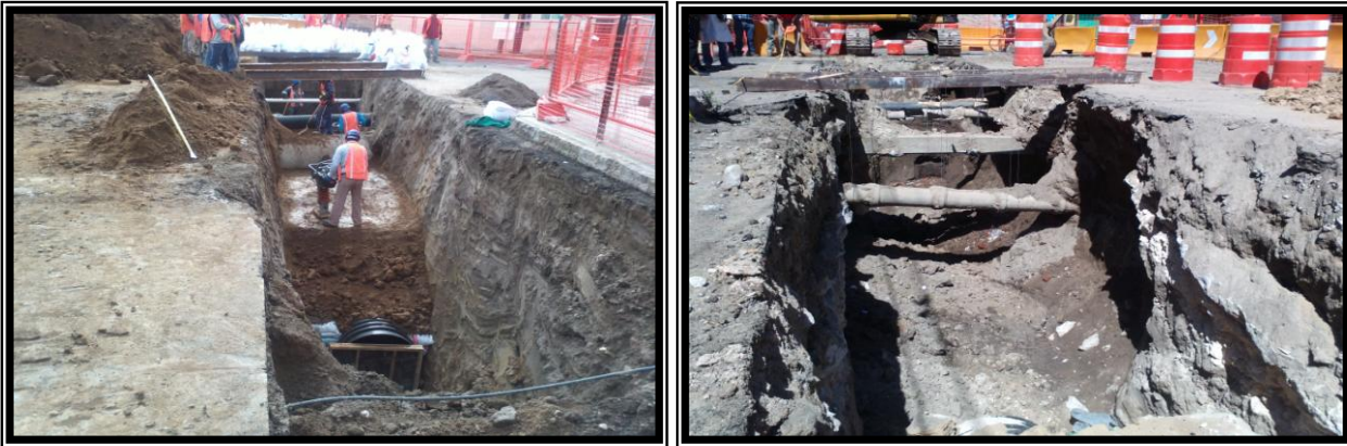
Figura 2.4.1 (izq. y der.) Líneas encontradas de agua potable, fibra óptica de TELMEX y alcantarillado durante un trabajo de excavación
