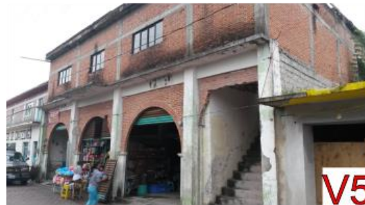
Sobre la Avenida Mariano Matamoros, frente al parque se ubica el Mercado Municipal, un poco deteriorado debido a falta de mantenimiento
