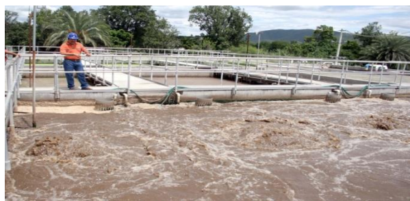
Fotografía 9. Planta Tratadora en funcionamiento
