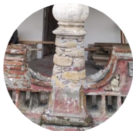
FT.3 DESPRENDIMIENTO DE APLANADOS Y DISGREGACIÓN DE MORTERO POR INTEMPERISMO Y FALTA DE MANTENIMIENTO EN FUSTE DE COLUMNA
