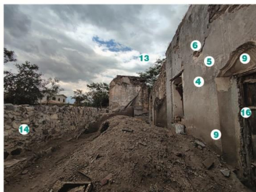
Fotografía 1. Estado actual de deterioro del área de lo que era la cocina en Casa Palestina. Pérdida de elementos estructurales (cubierta y muros). Se observa parte del material de colapso de muros al centro del espacio.
