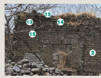
Fotografía 7. Paramento exterior de sección 3 (eje B' entre ejes 4 y 5') presenta pérdida de aplanados y erosión de adobe, oquedades por fauna nociva y fisuras multidireccionales por vegetación parásita.
