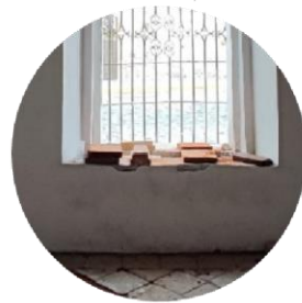
FT.8 MANCHAS POR HUMEDAD POR CAPILARIDAD Y DESPRENDIMIENTO DE APLANADO EN ANTEPECHO DE VANO DEL LOCAL 4
