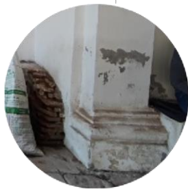
FT.2 PÉRDIDA DE PINTURA EN PARTE INFERIOR DE FUSTE DE PILASTRA DEL LOCAL 2
