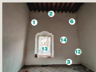
Fotografía 2. Deterioros de piso, muro y cubierta de eje 1 entre ejes A-B (sección 1). Presenta suciedad en encuentro de muros, humedad por capilaridad en parte baja de muro y sustitución de piezas de barro en piso.
