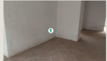
Fotografía 10. Humedad por capilaridad en partes bajas de muros.
