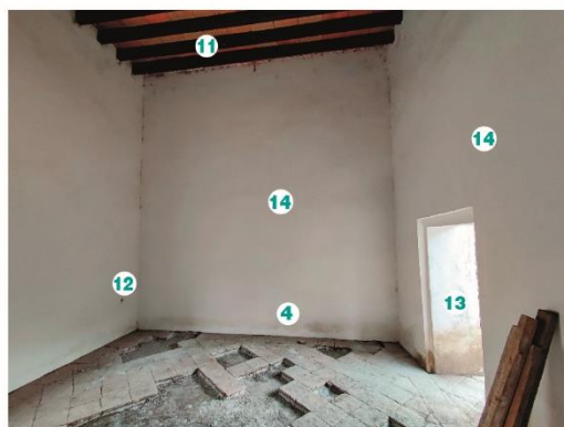
Fotografía 1. Deterioros y alteraciones del local 5 de Casa Palestina.
