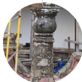
FT.9 MANCHAS DE SUCIEDAD POR DEPÓSITO DEBIDO AL INTEMPERISMO Y FALTA DE MANTENIMIENTO EN COLUMNA DE PÓRTICO
