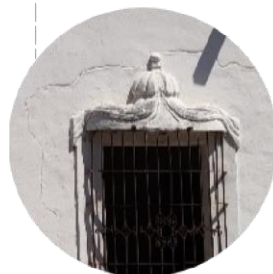
FT.8 MANCHAS DE SUCIEDAD POR DEPÓSITO DE POLVO EN ELEMENTOS ORNAMENTALES
