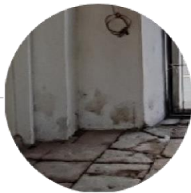
FT.4 MANCHAS POR HUMEDAD POR CAPILARIDAD EN PARTE INFERIOR DE ACCESO AL ZAGUÁN (LOCAL 2)
