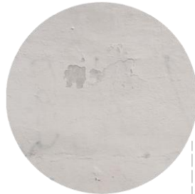
FT.2 PÉRDIDA DE PINTURA POR FALTA DE ADHERENCIA EN CENTRO DE PARAMENTO
