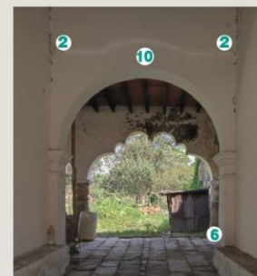
Fotografía 4. Suciedad por acumulación de polvo en esquinas de muro, pérdida de pintura en parte baja de pilastra e integración de nuevos aplanados como alteración (sección 4).
