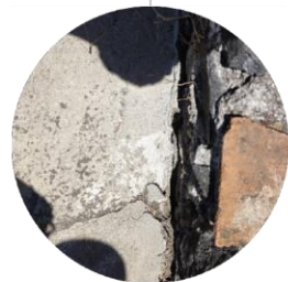
FT.6 JUNTA DE 1 CM ENTRE MUROS OCASIONA FILTRACIÓN DE AGUA PLUVIAL
