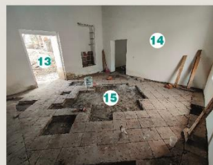
Fotografía 6. Alteración del piso, retiro de piezas rotas de barro cocido, conservando la misma base de suelo natural.
