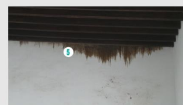
Fotografía 6. Manchas de guano en enrase de muro (sección 2). El espacio entre muro y viga es utilizado como refugio por murciélagos.
