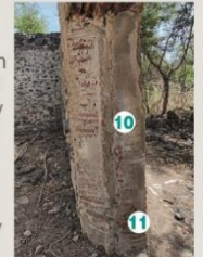
Fotografía 8. Deterioro en derrame de vano de sección 3 (eje B entre ejes 5' y 7), presenta pérdida de aplanados y pintura, disgregación de mortero en las juntas de la mampostería y suciedad por intemperismo.
