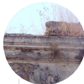
FT.4 FISURAS MULTIDIRECCIONALES Y PÉRDIDA DE APLANADOS EN ARCADEA DE PÓRTICO. COLAPSO DE PRETIL POR MOVIMIENTOS SÍSMICOS Y DEFECTOS DE FÁBRICA
