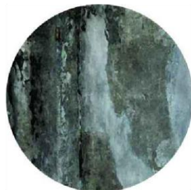
FT.1 MANCHAS POR FILTRACIÓN DE AGUA Y COLONIZACIÓN BIOLÓGICA EN ARCADEA DE PÓRTICO
