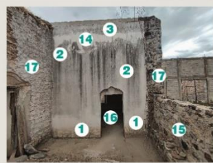
Fotografía 2. Sección 1 (eje 2 entre ejes A y B) presenta manchas por escurrimiento de agua pluvial en parte superior de muro, manchas por humedad por capilaridad en la zona baja y alteraciones como la integración de resane de cal en parte superior del paramento.
