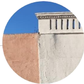
FT.1 GRIETA DESCENDENTE POR ACTIVIDAD SISMICA EN ESQUINA SUPERIOR IZQUIERDA DEL PARAMENTO
