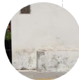
FT.9 MANCHAS POR HUMEDAD POR CAPILARIDAD EN APLANADO Y PINTURA DE SOBRECIMIENTO Y POYOS
