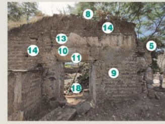
Fotografía 4. Vista de sección 3 (eje B' entre ejes 4 y 5') presenta colapso de parte derecha de muro de adobe y enrase de la zona izquierda, pérdida de aplanados en todo el muro y en algunas secciones del vano. Pérdida de pintura en aplanados de cerramiento de vano.
