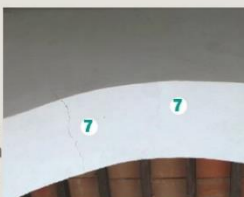
Fotografía 8. Detalle de fisuras horizontales en contraclave de arco (sección 4).
