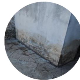
FT.8 MANCHAS POR HUMEDAD POR CAPILARIDAD EN PARTE BAJA DE MURO DE LOCAL 6
