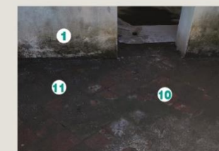
Fotografía 7. El piso presenta cambios de tonalidad en el material debido al intemperismo, secciones alteradas con capas de mortero en su superficie y presencia de musgo.
