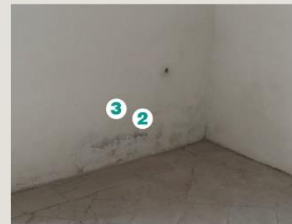
Fotografía 5. Sección 1, manchas por humedad por capilaridad y desprendimiento de pintura en parte baja de muro.
