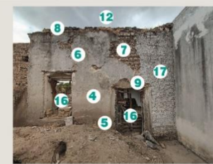
Fotografía 4. Sección 3 (eje B entre ejes 2-3') presenta pérdida de pintura, fisuramiento y pérdida de aplanados, disgregación de adobe, humedad y presencia de vegetación parásita. Se observa la integración de malla electrosoldada y mortero cemento-arena en parte derecha del muro.
