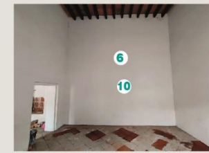
Fotografía 4. Paramento de sección 4, presenta pérdida de verticalidad y de manera superficial, manchas por suciedad en esquinas superiores.
