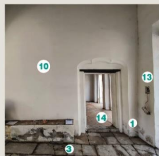
Fotografía 2. Muro (sección 2) alterado con aplanados y pintura recientes. Otras alteraciones son el ranurado para instalación eléctrica y la colocación de tablero eléctrico.
