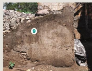
Fotografía 5. Sección 4 (eje 3' entre ejes A-B) pérdida de parte superior del muro, manchas por intemperismo, pérdida de pintura y aplanado.
