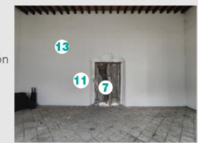
Fotografía 5. Alteraciones por ranurado para salidas eléctricas y nuevos aplanados. La puerta presenta cambio de tonalidad y acanaladuras en la superficie.
