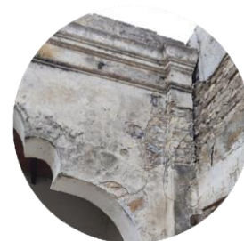
FT.5 DESPRENDIMIENTO DE APLANADOS EN ARCADEA Y PILASTRA DE PÓRTICO POR INTEMPERISMO
