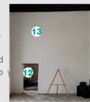
Fotografía 4. Vista de muro (sección 3), alterado con la integración de nuevos aplanados y pintura, además, presenta pérdida de verticalidad.
