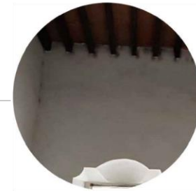
FT.9 MANCHAS DE SUCIEDAD POR FALTA DE MANTENIMIENTO EN ENRASE DE MURO Y DE MADERA EN VIGAS DE LOCAL 5
