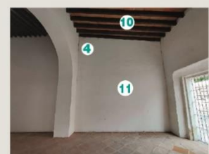
Fotografía 2. Muro (sección 2) alterado con aplanados y pintura recientes.
