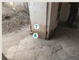
Fotografía 5. Parte baja de muro de sección 4 (eje 2 entre ejes A-B), manchas de humedad en zona baja de muro ocasionada por salpicadura de agua de lluvia y manchas por suciedad y exposición directa al exterior.
