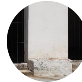
FT. 5 FISURA VERTICAL ASCENDENTE POR ACTIVIDAD SISMICA EN PARTE INFERIOR DE PARAMENTO
