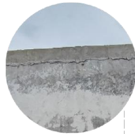
FT.6 FISURA HORIZONTAL EN APLANADO POR DEFICIENCIA CONSTRUCTIVA DE PARTE SUPERIOR DE MURO EN LOCAL 6
