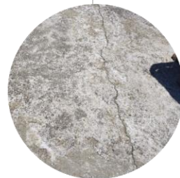
FT.8 FISURA POR TEMPERATURA EN ENTORTADO DE CONCRETO DE LOSA DE PÓRTICO
