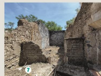
Fotografía 5. Muros divisorios de sección 4 (eje 5' entre ejes A y B') presentan pérdida de parte superior de muro, pérdida de verticalidad, disgregación de adobe y pérdida de aplanados.
