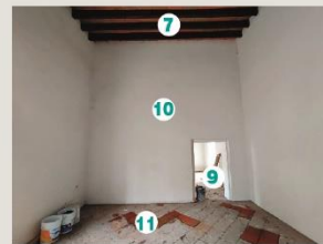
Fotografía 2. Muro de sección 2 alterado con aplanados y pintura recientes. Presenta suciedad acumulada en la parte superior de los encuentros entre muros.
