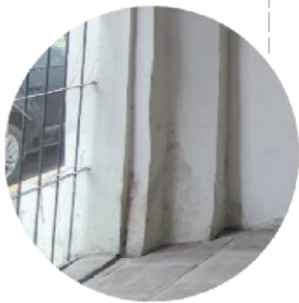
FT.3 MANCHAS POR HUMEDAD POR CAPILARIDAD EN PARTE INFERIOR DE VANOS DEL LOCAL 1
