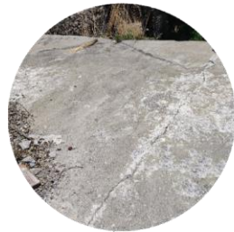
FT.2 FISURA TRANSVERSAL POR TEMPERATURA EN ENTORTADO DE CONCRETO EN CUBIERTA DE PÓRTICO
