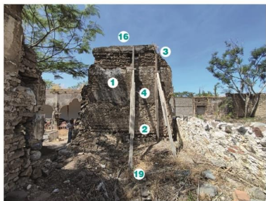
Fotografía 1. Deterioros y alteraciones en local 8. El espacio ha perdido elementos constructivos como la cubierta, secciones de muros de adobe, aplanados y pintura originales.
