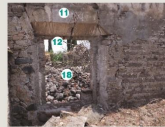
Fotografía 6. Detalle de vano de sección 3 (eje B' entre ejes 4 y 5'). Presenta pérdida de aplanados y pintura, grieta vertical en centro de cerramiento y deformación.
