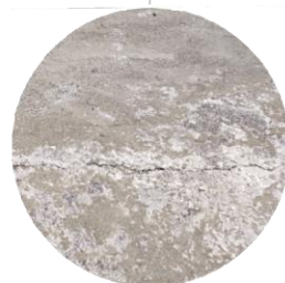
FT.7 FISURA TRANSVERSAL POR TEMPERATURA EN ENTORTADO DE CONCRETO DE LOSA DE PÓRTICO
