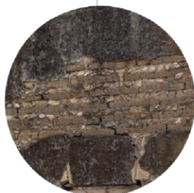
FT.6 DESPRENDIMIENTO DE APLANADO EN ZONA MEDIA DE MURO Y GRIETA INCLINADA DESCENDENTE POR ACTIVIDAD SÍSMICA Y DEFECTOS DE FÁBRICA EN CENTRO SUPERIOR DE MURO
