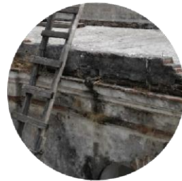
FT.3 ROTURA DE GÁRGOLA POR MALA COLOCACIÓN Y FALTA DE MANTENIMIENTO EN LOSA DE PÓRTICO
