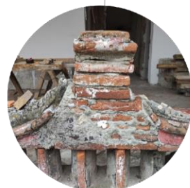
FT.8 PÉRDIDA DE RECUBRIMIENTO Y DISGREGACIÓN DE MORTERO POR INTEMPERISMO EN CONTRA ARCOS Y CELOSÍA DE PÓRTICO
