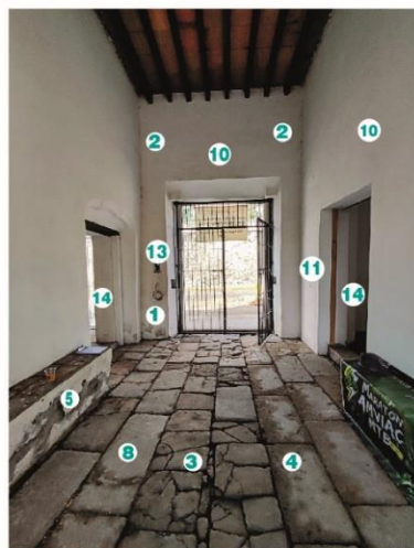
Fotografía 1. Zaguán (local 2) de Casa Palestina, vista del muro del eje 1 entre ejes D-E (sección 1).
