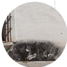
FT.7 MANCHAS POR COLONIZACIÓN BIOLÓGICA (MOHO) EN PARTE INFERIOR DE PARAMENTO
