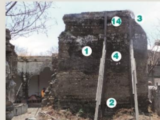
Fotografía 2. Vista de sección 1 (eje 4 entre ejes A y B'), el muro presenta pérdida de verticalidad y falta de muros laterales que refuercen su estructura, pérdida de aplanados y secciones superiores de muro; los aplanados que se conservan presentan manchas por suciedad y humedad debido al intemperismo.
