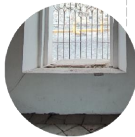
FT.6 DESPRENDIMIENTO DE APLANADO POR FALLA CONSTRUCTIVA EN ANTEPECHO DE VANO DERECHO DEL LOCAL 3
