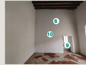
Fotografía 3. Muro de sección 3 alterado con la integración de nuevos aplanados y pintura, pérdida de verticalidad y deformación en la parte superior.
