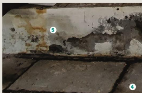
Fotografía 3. Poyo en sección 2 presenta manchas y eflorescencia por humedad por capilaridad, así como pérdida de aplanado y pintura.
