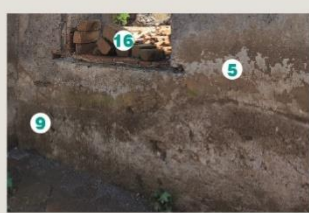
Fotografía 6. Detalle de parte baja del muro de Sección 3. Presenta pérdida de pintura, disgregación del material, manchas por suciedad y humedad por intemperismo.
