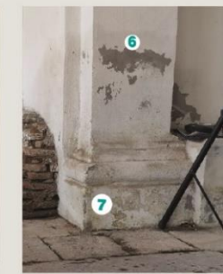
Fotografía 5. Manchas por humedad por capilaridad, pérdida de pintura y aplanado, base de pilastra (sección 4).
