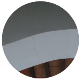
FT.1 FISURAS VERTICALES EN CONTRAclave DE ARCO DE MEDIO PUNTO EN LOCAL 1
