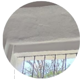
FT.1 FISURA VERTICAL ASCENDENTE POR ACTIVIDAD SISMICA EN CAPIALZADO DE VANO DEL LOCAL 1
