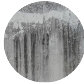
FT.7 MANCHAS POR SUCIEDAD Y ESCURRIMIENTO DE AGUA PLUVIAL EN PARTE SUPERIOR Y MEDIA DE MURO EN LOCAL 6
