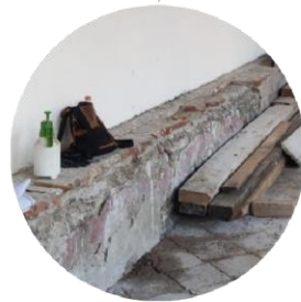
FT.5 ROTURA DE CUADRADOS DE BARRO, PÉRDIDA DE APLANADOS Y DISGREGACIÓN DE MORTERO EN POYOS DE LOCAL 12 (PÓRTICO)
