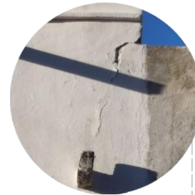
FT.4 GRIETA DESCENDENTE POR ACTIVIDAD SISMICA EN ESQUINA SUPERIOR DERECHA DE PARAMENTO
