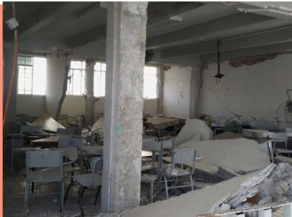
Imagen 16. Daños ocasionados por el sismo del 19/09/17 en el Centro Escolar Presidente Lázaro Cárdenas. Izúcar de Matamoros, Puebla.
