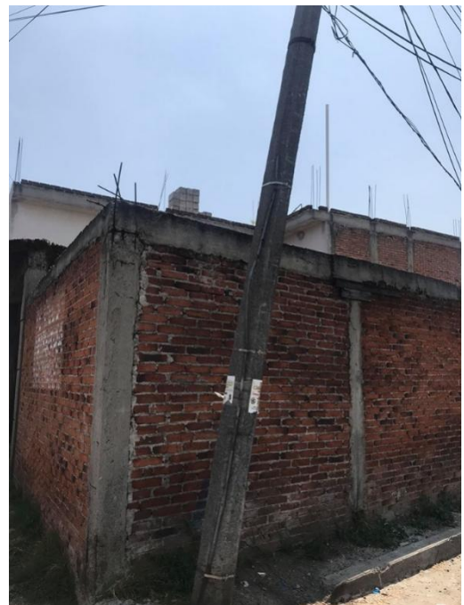
Foto 10; obstrucción peatonal. Fotografía propia.
