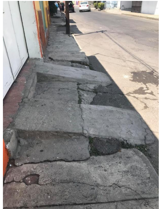
Foto 12; obstrucción peatonal. Fotografía propia.
