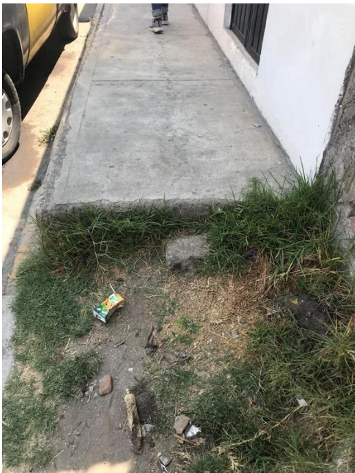
Foto 6; falta de mantenimiento. Fotografía propia.
