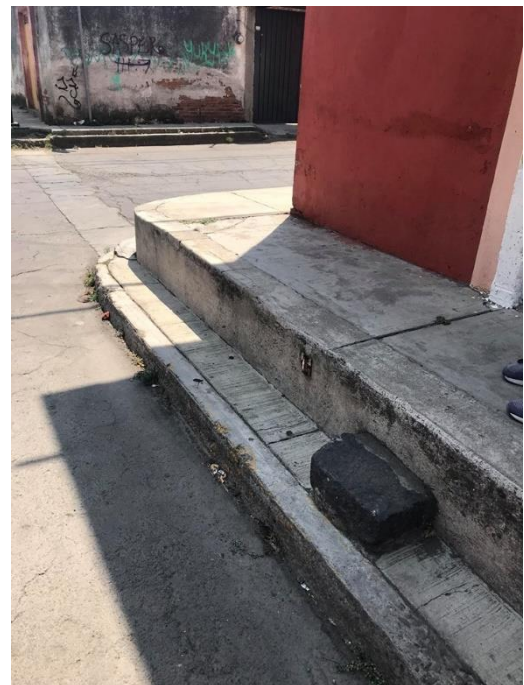
Foto 5; obstrucción peatonal. Fotografía propia.
