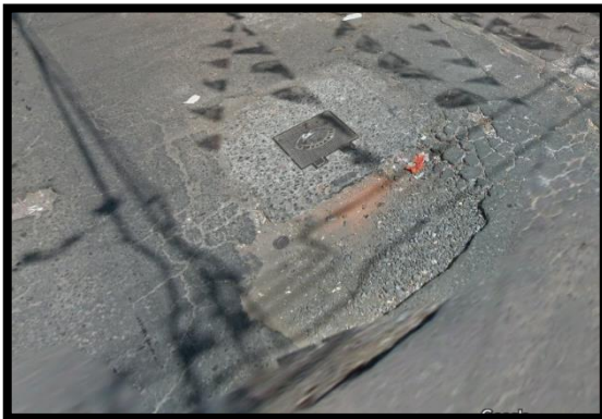
Fig. 5; Falta de mantenimiento en calle 3 norte. (Google Maps, enero 2020).
