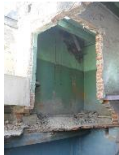
Ilustración 24 Núñez Gina, Sánchez Jacqueline. 2013. Actualmente ésta parte de la casona es la más dañada estructuralmente. Losas y muros se han vencido por la falta del mantenimiento y una estructura rígida que soportara el peso de éstos elementos estructurales.
