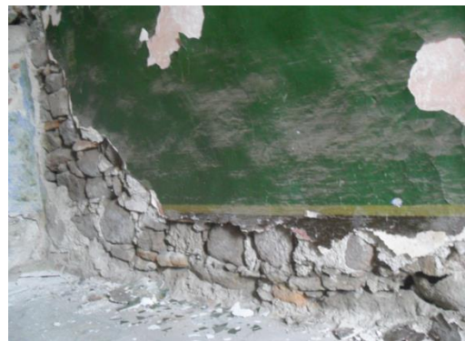
Ilustración 17 Núñez Gina, Sánchez Jacqueline. 2013. Detalle de muro de limosna, muro de la primera etapa de construcción. Debido a la presencia de humedad se encuentra en mal estado repellido y pinturas. Se perciben las distintas capas y calidades de pintura que el muro ha recibido.
