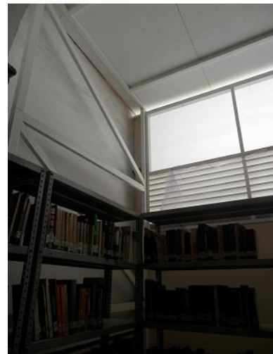
Ilustración 10. Núñez G. 2014. Cancelería colocada para ventilación, hoy en día clausuradas por las fuertes ráfagas de viento que se producen en el patio.
