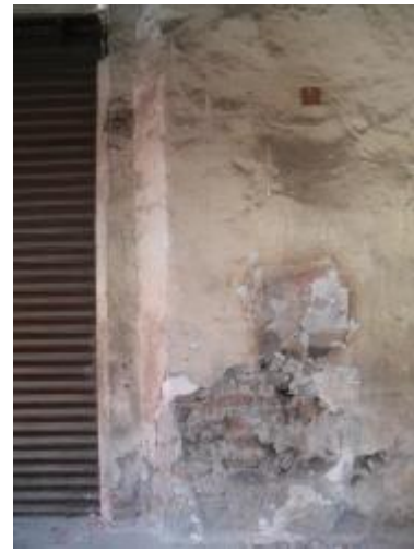
Ilustración 15 Núñez Gina, Sánchez Jacqueline. 2013. Tercera etapa de construcción de la vivienda, la humedad que presenta el muro hace que se observe el sistema constructivo del muro, formado de tabique con mortero.
