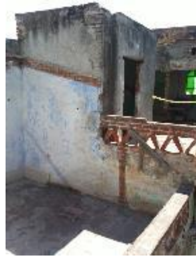
Ilustración 26 Espacio 27. Disgregación de materiales por estar expuestos a la intemperie. Núñez Gina, Sánchez Jacqueline. 2013.
