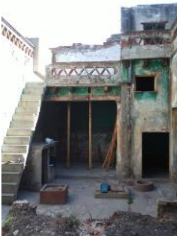
Ilustración 5 Muros del patio interior de la casona. Se observa la escalera que es considerada de la segunda etapa, está soportada por un riel de una vía ferroviaria. Núñez Gina, Sánchez Jacqueline. 2013.
