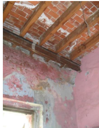
Ilustración 18 Núñez Gina, Sánchez Jacqueline. 2013. Detalle de losa de la primera etapa, las vigas de madera se encuentran en condiciones para ser rehabilitadas. Se encuentran reforzadas por vigas de acero (segunda etapa de construcción).
