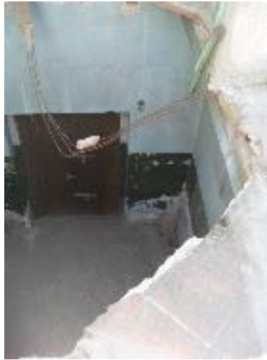
Ilustración 25 Núñez Gina, Sánchez Jacqueline. 2013. Se observa claramente la falta de piso y el debilitamiento de la estructura que se encuentra expuesta.
