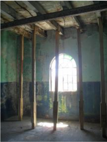
Ilustración 9 Apuntalamiento de losas en el segundo nivel de la casona, estructuralmente la mayoría de éstas se encuentran debilitadas. Núñez Gina, Sánchez Jacqueline. 2013.
