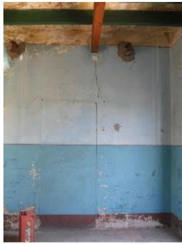
Ilustración 11 Tapiado de muros, debido a que éste inmueble llegó a ser utilizado como una vecindad. En la losa se puede observar el refuerzo de las vigas de madera con el uso de vigas de acero (material usado a principios del S.XX). Núñez Gina, Sánchez Jacqueline. 2013.
