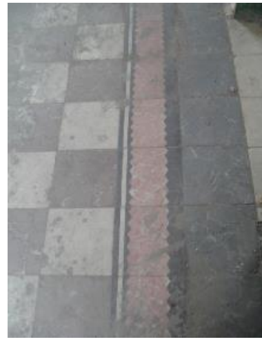
Ilustración 10 La mayoría de los pisos en éste nivel se encuentran fracturados y en mal estado, éste tipo de losetas comenzaron a ser usados en las viviendas a principios del S.XX. Núñez Gina, Sánchez Jacqueline. 2013.
