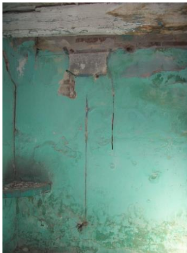
Ilustración 27 Núñez Gina, Sánchez Jacqueline. 2013. Espacio 29. Muros en malas condiciones, debido a la presencia de humedad.
