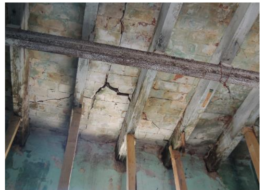
Ilustración 28 Núñez Gina, Sánchez Jacqueline. 2013. Espacio 32. Losas debilitadas y en malas condiciones, actualmente el apuntalamiento ha evitado que éstas se desplomen.
