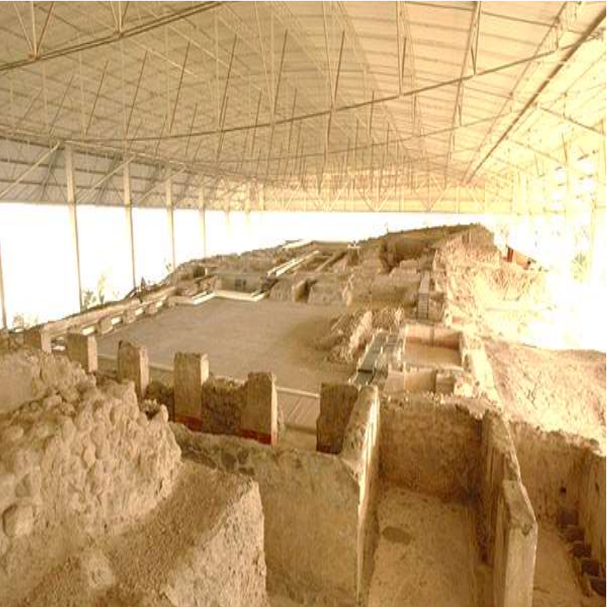
Cubierta de protección en los basamentos de Cacaxtla, Tlaxcala. Intervención curativa. Fuente https://mx.imaaes.search.vahoo.com/search/imaaes 15/03/17 18:05
