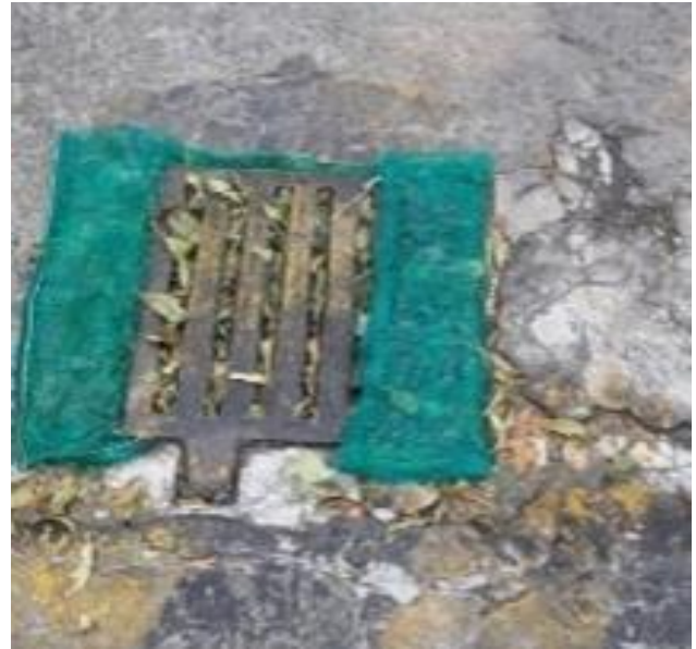
Figura 51. Imagen de alcantarillado (Sánchez, 2018)
