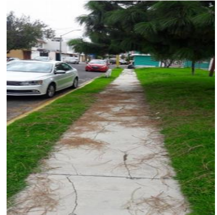
Figura 54. Estado actual de las banquetas. (Sánchez, 2018)
