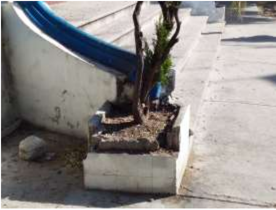
Imagen 95. Deterioro en jardinera de escalera; Parque de la Pérgola. Foto: MEDA.
