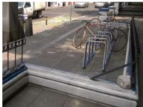
Imagen 106. Piezas faltantes en herrería que delimita el espacio, Jardín del Arte. Foto: MEDA.
