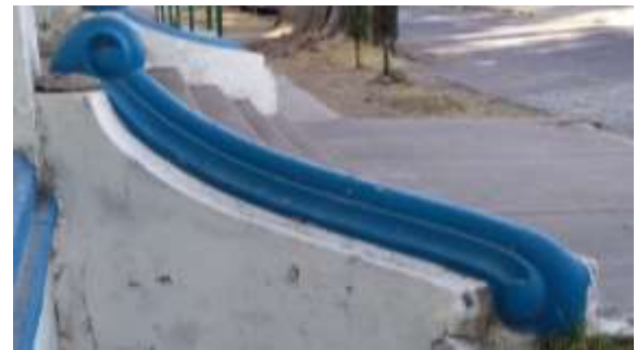
Imagen 98. Fisuras en roleos y alfardas de escalera; Parque de la Pérgola. Foto: MEDA.
