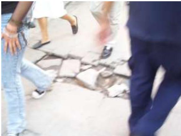
Imagen 13. Deterioro de pavimentos. Foto: MEDA.
