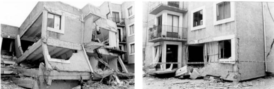
Figura 1.11 Daños causados por el sismo del 15.06.1999 Condominio en la calle 3 oriente, colonia Azcarate; Tomada de informe técnico del sismo de Tehuacán de 1995 (CENAPRED)
