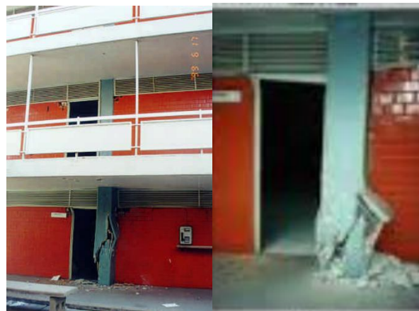
Figura 3.1 Daño en columna en edificio de Facultad de Medicina. Tomada de informe técnico del sismo de Tehuacán de 1995 (CENAPRED)
