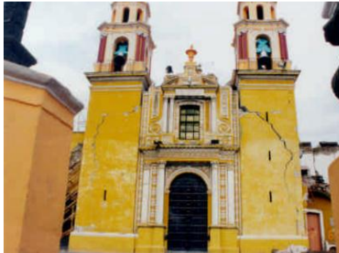
Figura 1.12 Daños causados por sismo del 15.06.1999, imagen de iglesia en el Municipio de Cholula.
