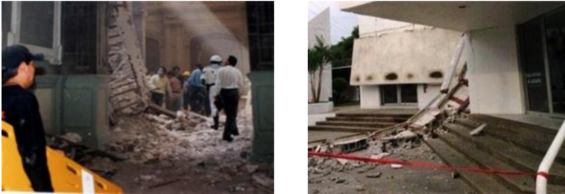
Figura 1.3 Daños causados por el sismo del 15.06.1999 en a) edificio de Ayuntamiento del municipio de Puebla y b) edificio de Gobierno (25 Oriente y 14 Sur (tomada de El Imparcial, 1999).
