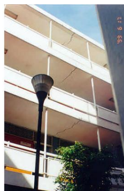
Figura 3.2 Daño en losas en edificio de Facultad de Medicina.
