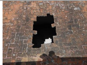
Detalle de deterioro avanzado en la cubierta
