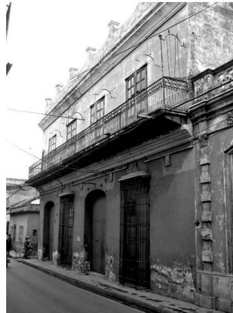
Fachada Poniente y Oriente del Palacio Pichardo y su identificación de deterioro, Camagüey, Cuba Foto: Aldair Fernández de Lara, Febrero 17, 2015
