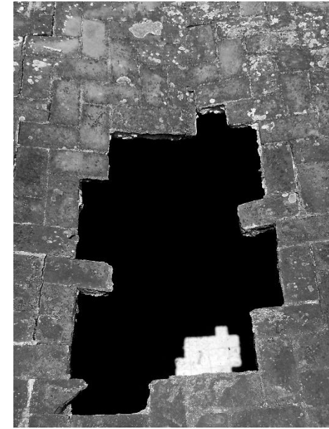
Registro de Deterioro Cubierta del Palacio Pichardo, Camagüey, Cuba Foto: Universidad de Camagüey, Febrero 17, 2015
