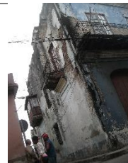
Bajante de Agua Pluvial a un costado de la fachada Foto: Aldair Fernández de Lara, Febrero 14, 2014
