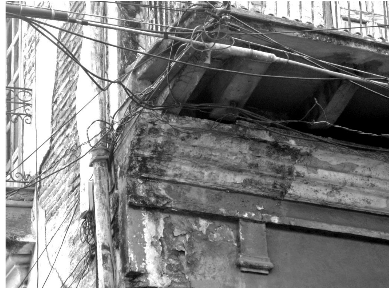
Redes Técnicas de Electricidad y Telefonía en mal estado Foto: Universidad de Camagüey, Febrero 17, 2015
