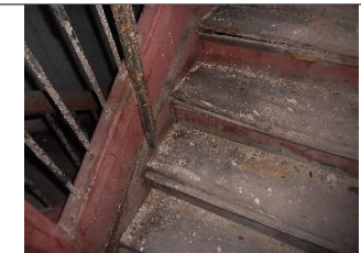
Deterioro de escalera de madera Foto: Aldair Fernández de Lara, Febrero 2015
