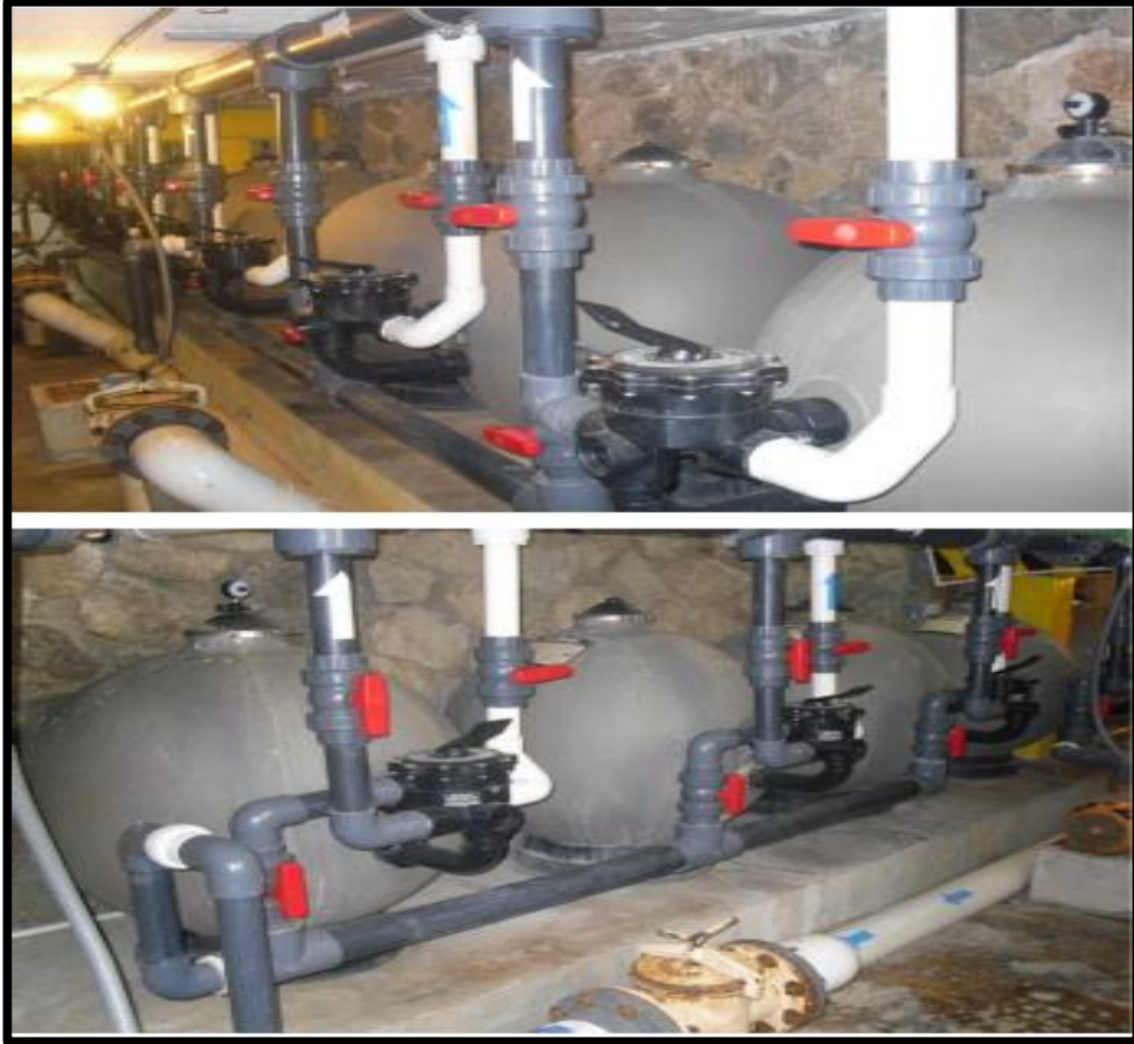
Ilustración 4.5 sistema de filtración y bomba para el tratamiento del agua de las albercas
