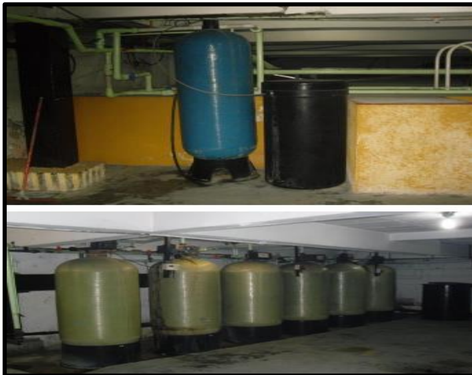
Ilustración 4.8 sistema de filtración y tratamiento de agua potable para el hotel
