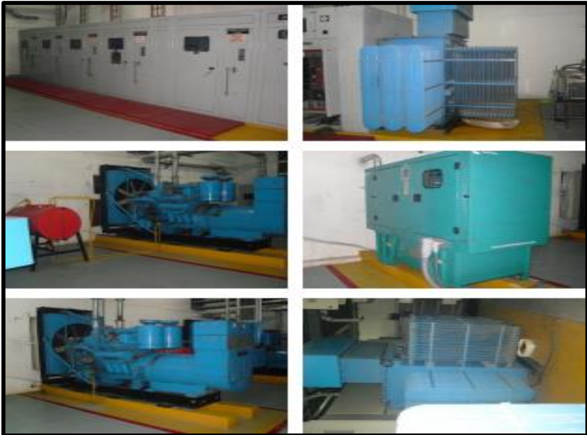
Ilustración 4.9 sistema electrógeno y subestación para la generación de energía eléctrica de respaldo
