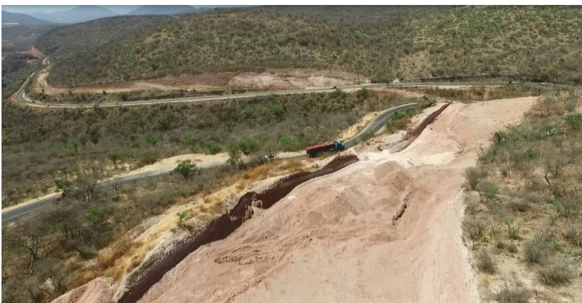
FIG. III.3.1.2 MODIFICACIONES GEOMORFOLOGICAS POR CORTES Y EXCAVACIONES; FUENTE: Elaboración propia
