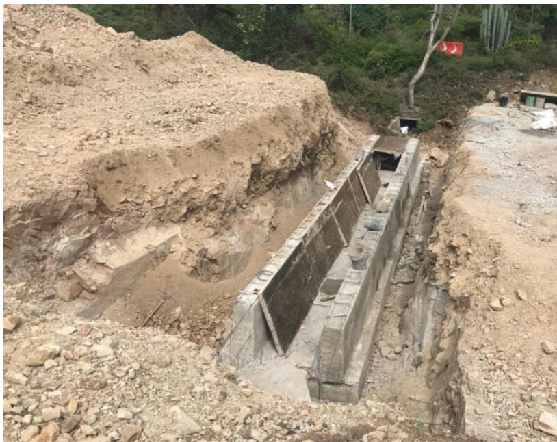
Fig. IV.5.3.2 CONSTRUCCION DE OBRAS DE DRENAJE A LO LARGO DEL TRAMO - LOSAS DE CONCRETO Fuente: Elaboración propia
