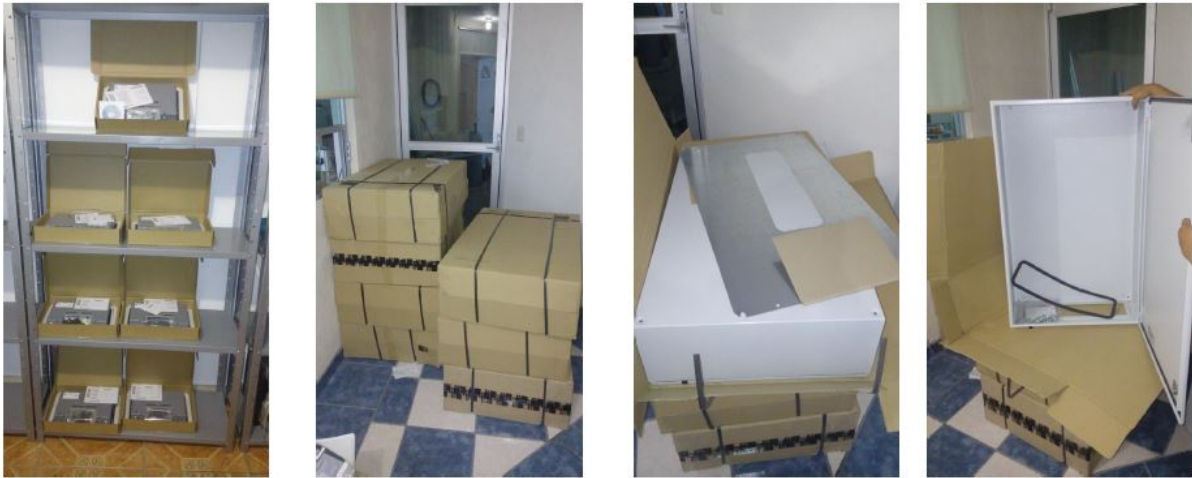
Figura 5.23: Tableros y PLCs
