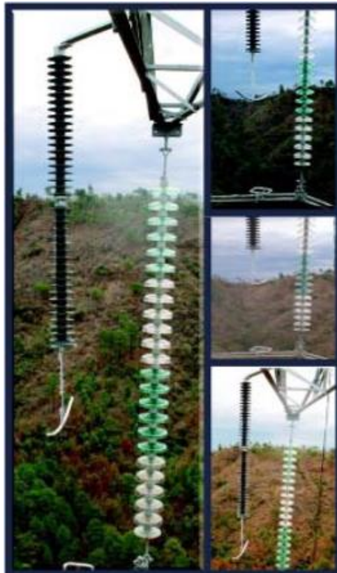
Figura 2.2.14.- Supresor de Sobretensiones por Descargas Atmosféricas.
