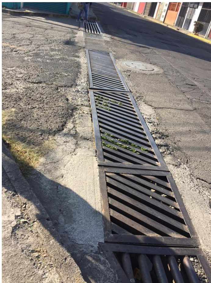
Ilustración. Alcantarillado en paso peatonal. Ana Karen. G. M. Enero 2017
