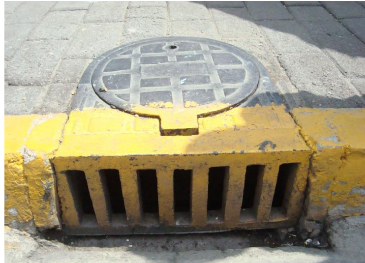
Imagen 28 Detalle de coladera pluvial con rejilla. (Fuente: fotografía propia de los autores).
