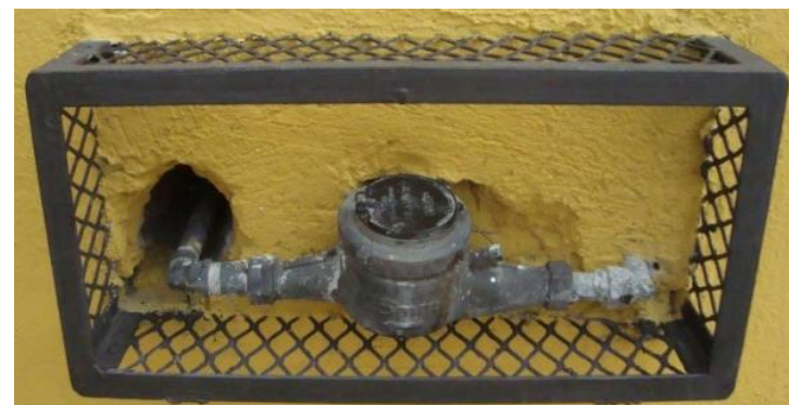
Imagen 25 Medidor de agua. (Fuente: fotografía propia de los autores).
