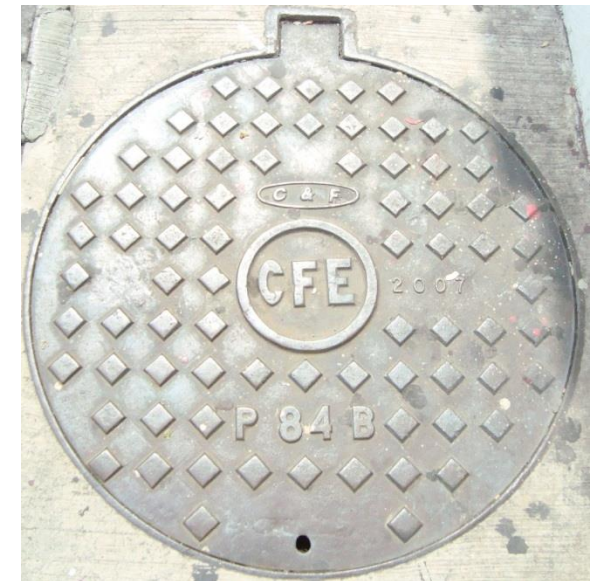
Imagen 30 Detalle de tapa de metal de un registro de la red eléctrica. (Fuente: fotografía propia de los autores).
