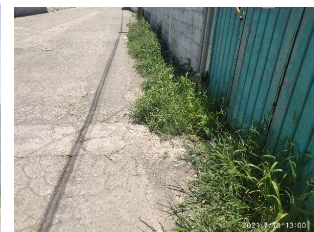
Imagen 92: Servicio de drenaje en Terreno destinado a proyecto. Fotografía tomada por Rosa María Luna Rosas, julio 2021
