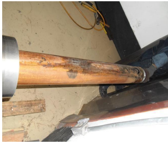
Figura 3.24.- Tubo de conexión del interior de la flecha.
