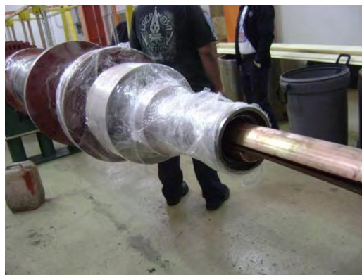
Figura 3.6a.- Aislamiento a tierra de la conexión central del Interior de la Flecha hueca.
