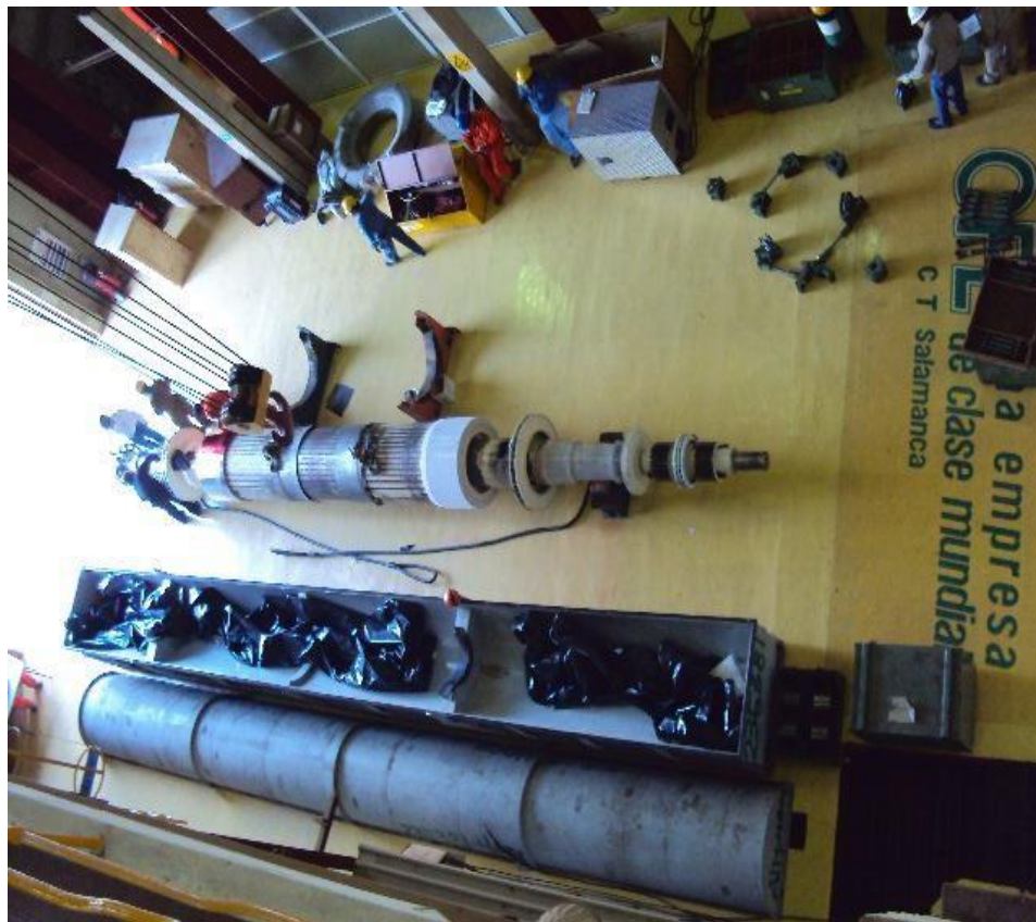
Foto 3.9 .- Rotor de reserva contaminado por falla en Estator, y su cilindro metálico de transporte.
