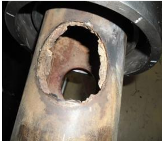
Figura 3.23.- Daños en punto de conexión.
