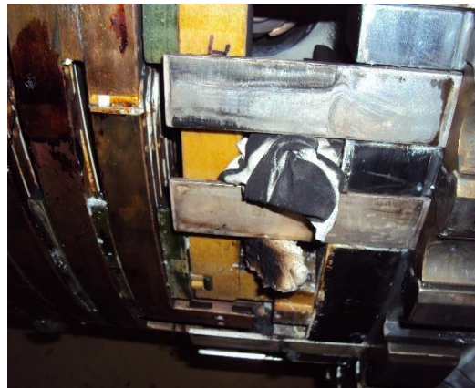
Figura 3. 16.- Trapo quemado encontrado bajo el anillo de retención lado excitador en el área de conexión.
