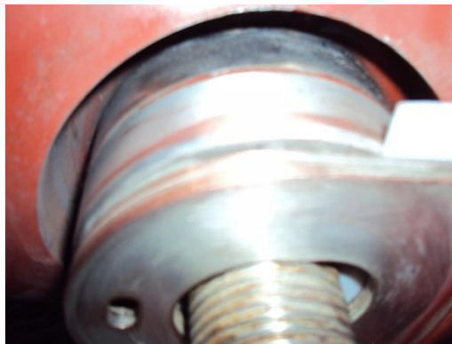
Figura 3.18.- Aislamiento quemado por arqueo a tierra en poste de conexión.
