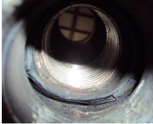
Figura 3.20 Aislamiento quemado en la parte interna de la conexión al interior de la flecha.
