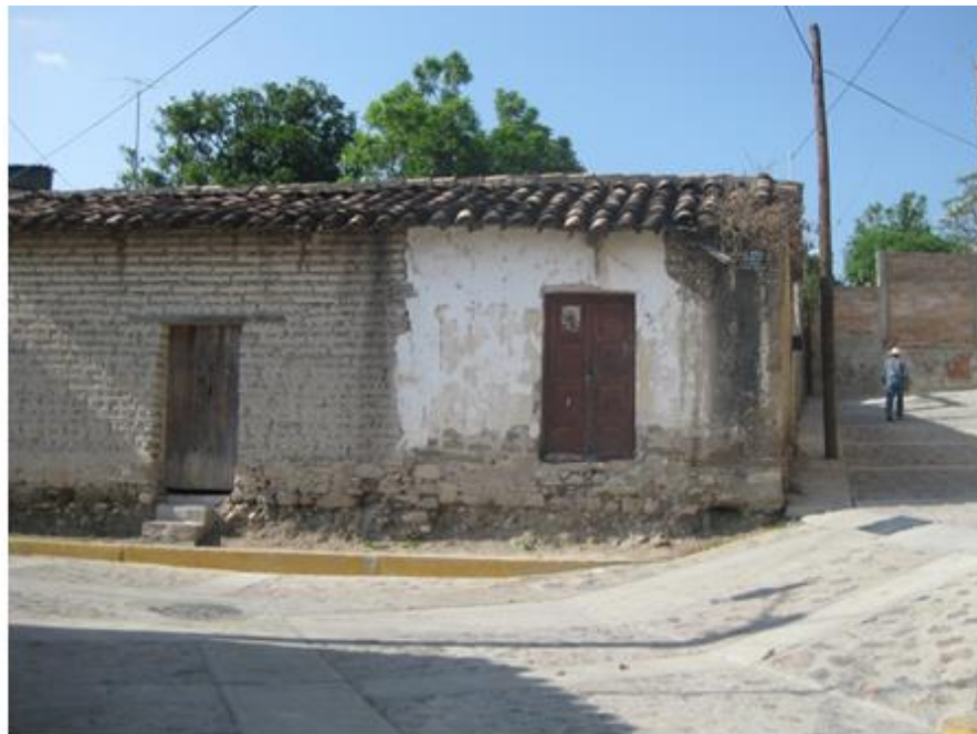
Imagen 64. Casa de dos aguas con material del adobe presenta deterioro. Fuente: Foto del autor, 2013.
