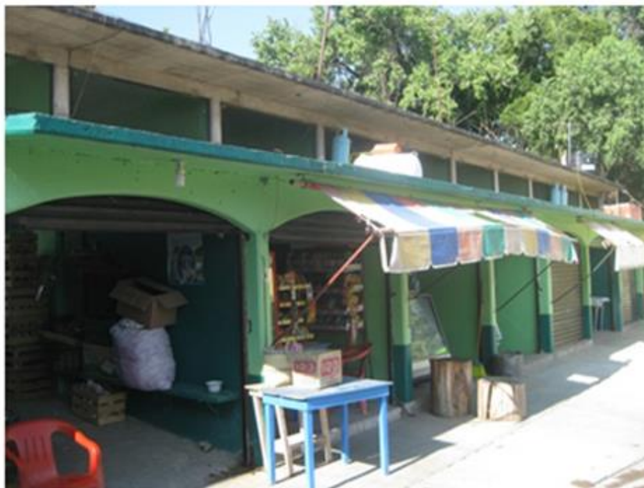
Imagen 46. El mercado se encuentra en malas condiciones ya que carece de mantenimiento
