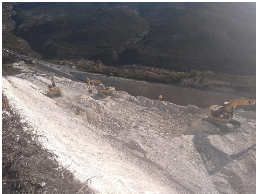
Figura 45.- Abatimiento de talud derecho.
