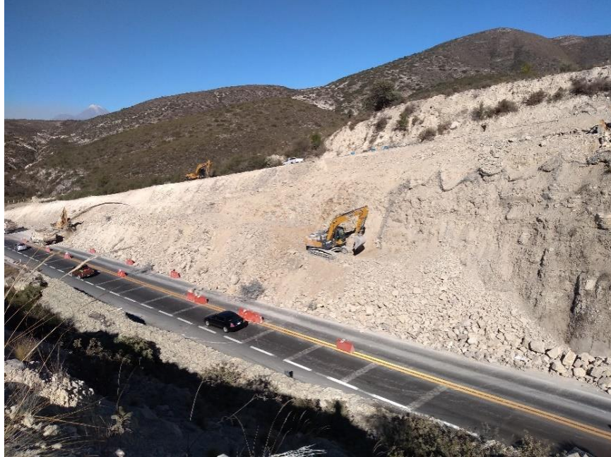
Figura 43.- Abatimiento de talud izquierdo I.
