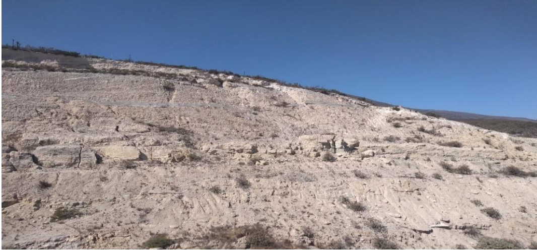
Figura 18.-Talud derecho km 19 de la autopista Cuacnopalan-Oaxaca.
