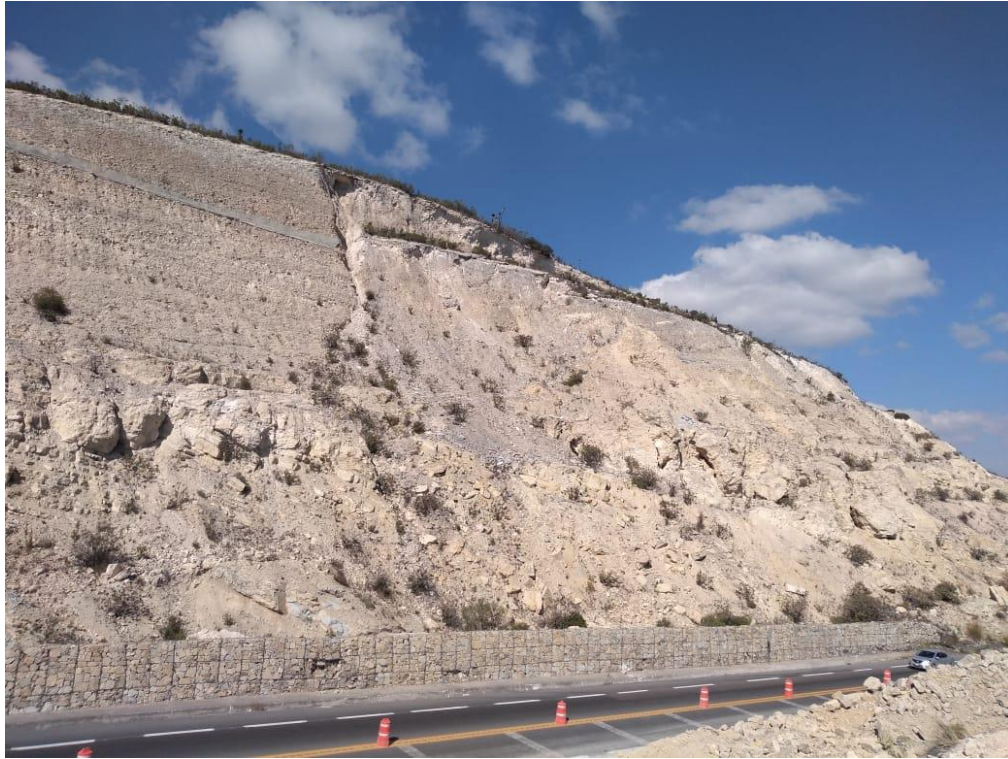
Figura 15.- Falla en talud derecho del km 19 de la autopista Cuacnopalan-Oaxaca.
