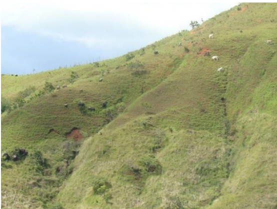
Figura 10.- Falla por reptación I.
