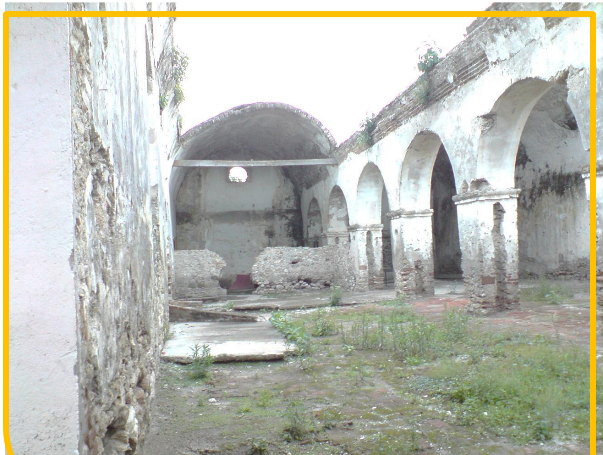
Imagen 3 - Parte dañada de la casa de Cultura
