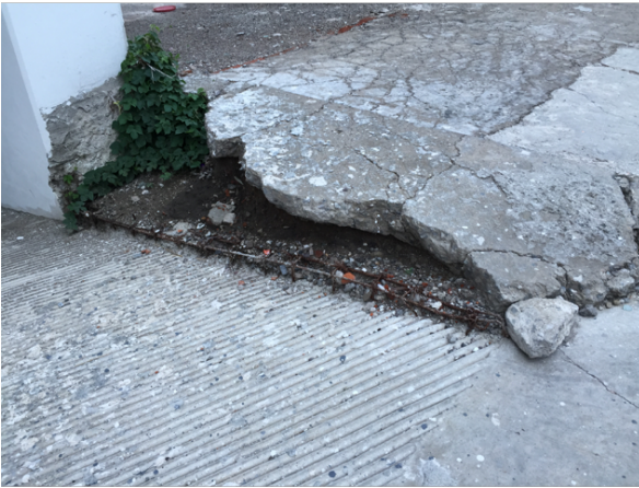
Pavimentos en mal estado
