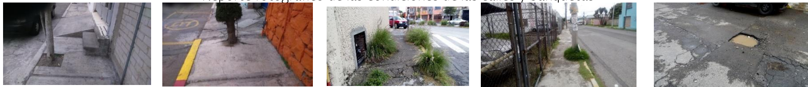
Figura 2.14 Levantamiento puntual realizado en campo de los cortes de las calles Morelos, Venustiano Carranza, Segunda Privada Benito Juárez, Avenida 15 de mayo y el cruceiro del Blvd Hermanos Serdán, se anexan fotos de las condiciones actuales de las calles y banquetas.
