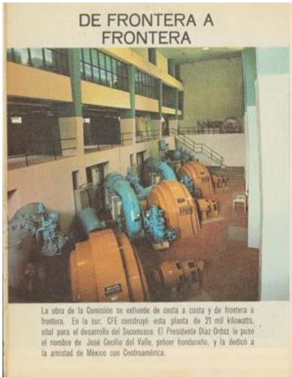
6. La obra de la Comisión se extiende de costa a costa y de frontera a frontera. En la sur, CFE construyó esta planta de 21 mil kilowatts, vital para el desarrollo del Soconusco. El Presidente Díaz Ordaz le puso el nombre de José Cecilio del Valle, prócer hondureño, y la dedicó a la amistad de México con Centroamérica.
