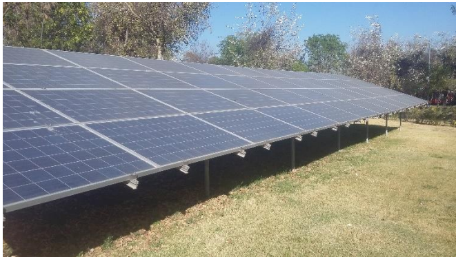
Figura 1.20: Vista de la zona donde se ubican las Paneles solares del Parque Ecológico. Fuente: Elaboración propia.
