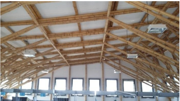
Figura 1.25: Imagen tomada dentro del parque Bicentenario 18 de Noviembre. Donde se pueden apreciar la estructura de bambú en el interior de la biblioteca del parque bicentenario.
