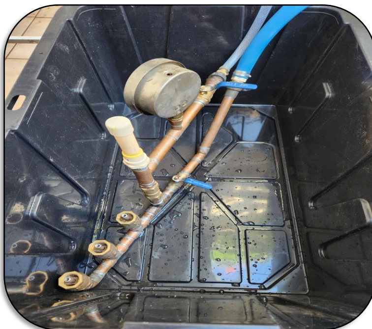
Imagen 12. Bomba de Ariete Hidráulico con tanque de aire de 10 cm (Escenario 2)
