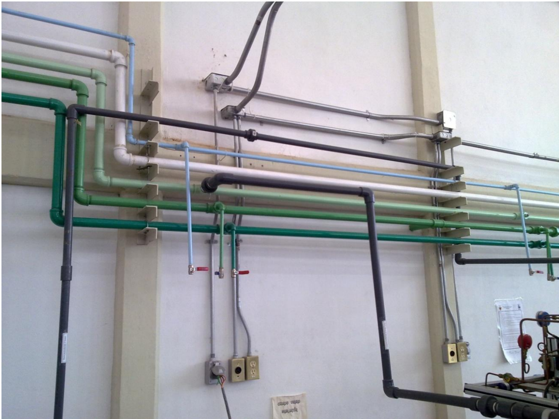
Figura 4.31.- Se muestran las tuberías que dan servicio alrededor del L.O.U.
