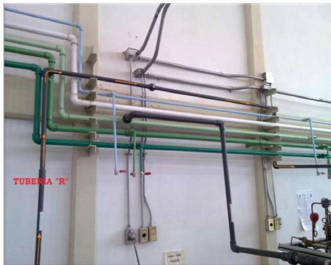
Figura 1. 3 Tubería "R" alimenta el tanque de enfriamiento con agua de desecho de los equipos.
