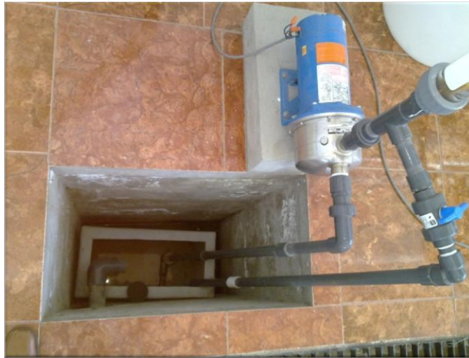
Figura 1. 2 Tanque receptor de agua de desecho de la línea de salida de los equipos.
