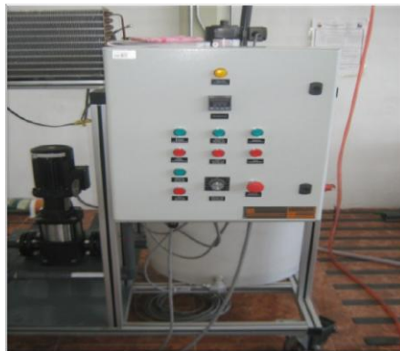
Figura 5. 24 Fotografía del Sistema de agua de enfriamiento del L.O.U.
