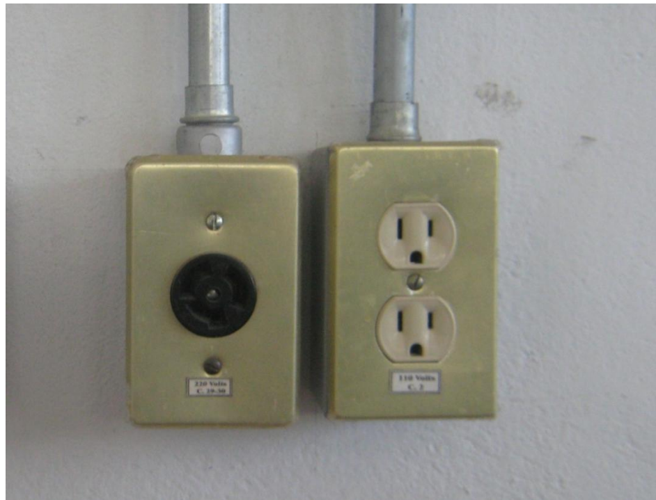
Figura 4.29.- Enchufes tomacorriente aterrizados de 120 volts. y enchufes tipo “C” europeo de corriente alterna a 220 volts.
