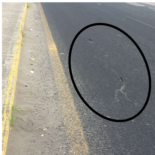
Ilustración 17; Grietas en borde, Carretera Federal México Puebla
