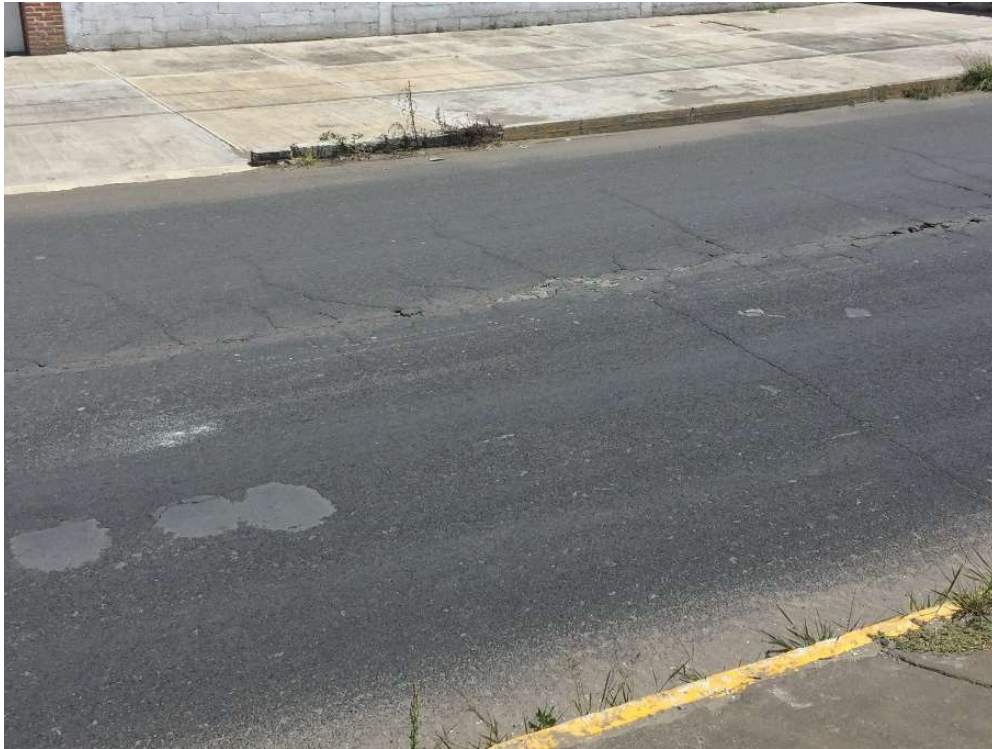
Ilustración 18: Fisuras o Grietas longitudinales, Carretera Fed. México Puebla km 96.5
