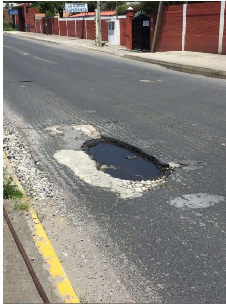
Ilustración 19: Bache abierto Severo, Carretera Federal Mexico Puebla km 96.5
