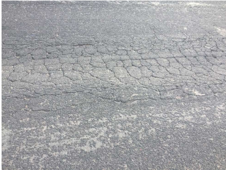
Ilustración 15; Falla por fatigamiento severa. Carretera Federal México Puebla Km 94.
