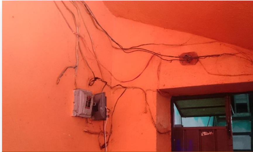
Foto 3.- Instalación eléctrica, interior de la casa, acceso principal.
