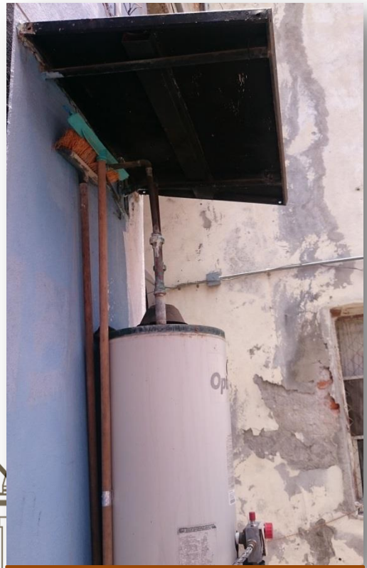
Foto 7.- Instalación de gas, interior de la casa, segundo patio.
