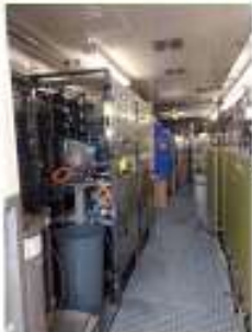
Tratamiento de los lixiviados del relleno saneado y en operación.
