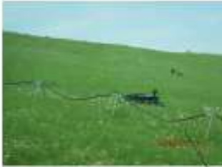
Captura de biogás del relleno saneado y en operación.
