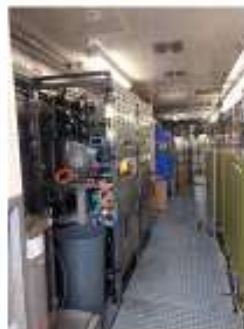
Planta de tratamiento de lixiviados
