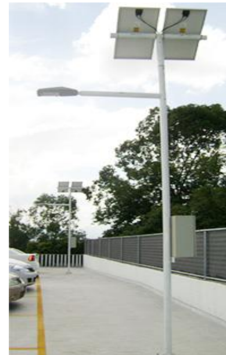
Poste de luz con celdas solares Fuente: http://www.iluminacionsolar.com.mx/
