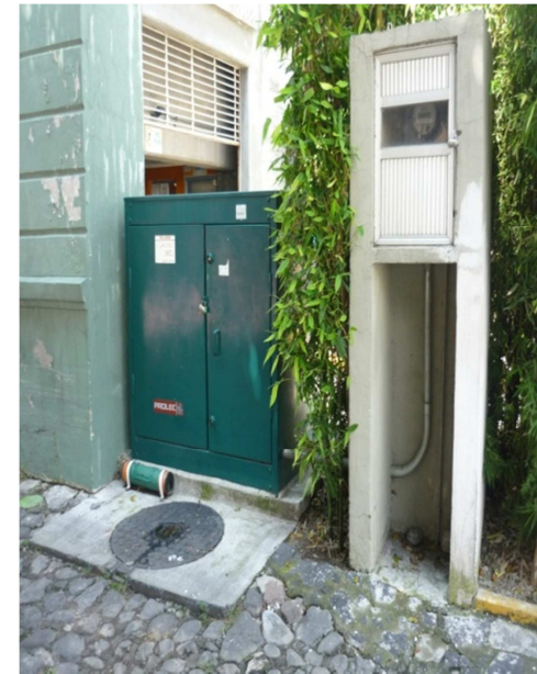
Registro de CFE Y Pozo de visita
