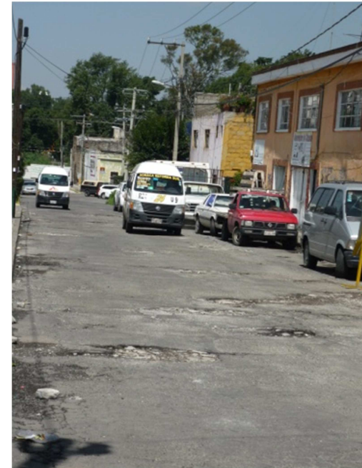
Foto 8.- Calle 16 oriente entre 16 y 14 sur, se observa los baches que provocan no haya buen flujo vehicular.
