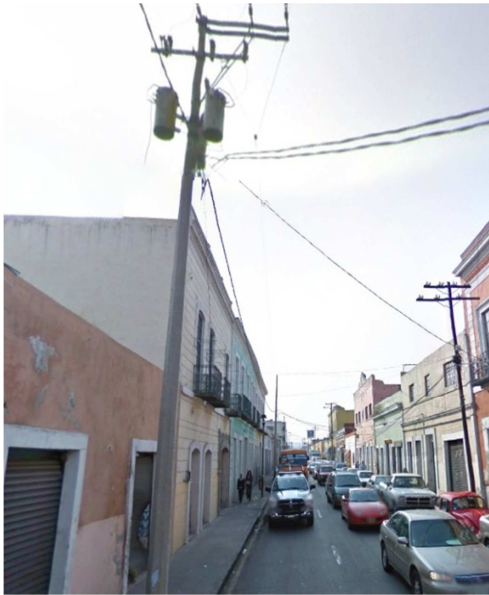
Poste de energía eléctrica con transformadores
