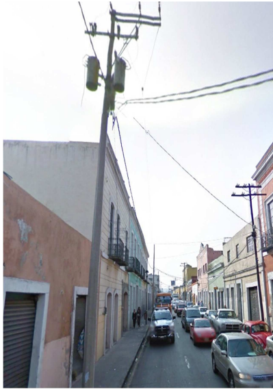
Foto 17.- Los postes no tienen ningún tipo de tratamiento, generalmente son de concreto o de madera, albergan instalaciones eléctricas y telefónicas. Existe algunos postes que han llegado a un grado de deterioro tal, que han sido sustituidos por nuevos, sin embargo no son removidos por lo que solo contribuyen a un mala imagen urbana.
