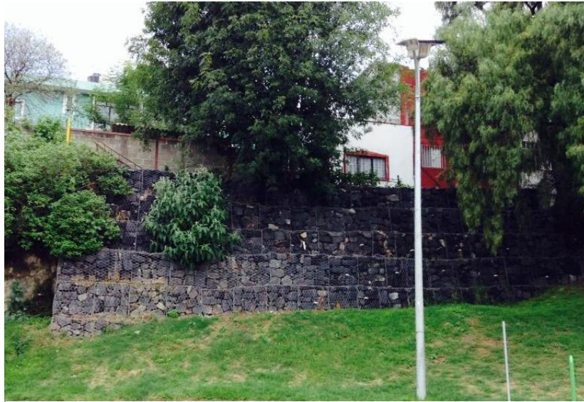
Ilustración 20. Foto de casa vulnerable a daños por el río con muros de gavión, Mischa Mora Millán. (06/2014)
