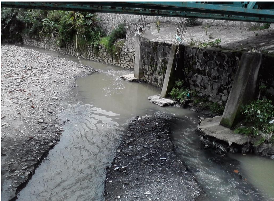
Ilustración 6. Vista de la planta tratadora de aguas residuales donde se ve cómo el agua está erosionando la margen del muro, Ana Karen Acua Hdz. (08/2014)
