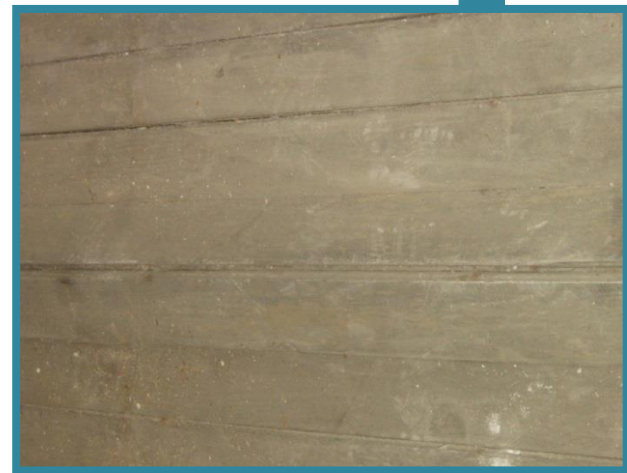
FOTO NO. 52: PISO DE MADERA BLAS, MORA, ORTIZ JULIO 2009
