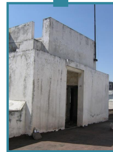
FOTO NO. 13: SALIDA HACIA AZOTEA BLAS, MORA, ORTIZ JULIO 2009
