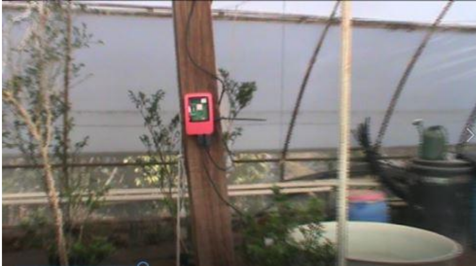
Figura 3.17. Instalación del sistema de monitoreo en el Invernadero
