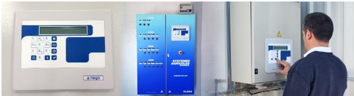
Figura 2.1. Tablero de algoritmos de control y de riego Fuente: Tomado de Novagric, Temporizador de Riego.
