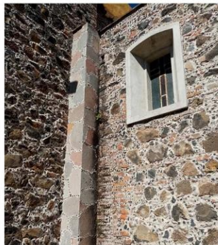
Imagen 6. Detalle de helecho en unión entre muro y pilastra.
