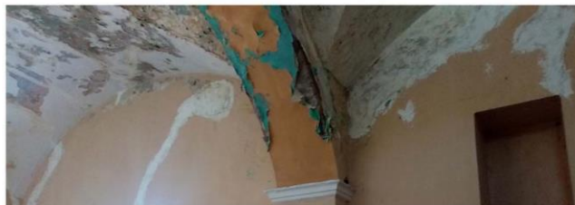
Imagen 5. Desprendimiento de aplanados en intradós del muro del arco que sostiene bóvedas de sacristía.
