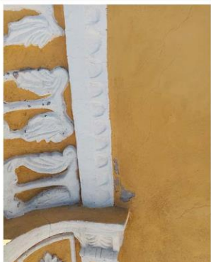
Imagen 5. Detalle de desprendimiento de pintura.
