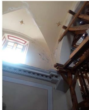
Imagen 3. Segundo tramo de la nave con suciedad en la bóveda de lunetos.
