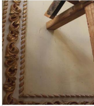
Imagen 2. Detalle de cimbra recargada en muro de transepto.
