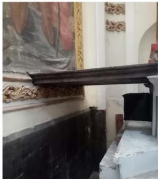
Imagen 3. Detalle de deterioros en pintura y yesería.
