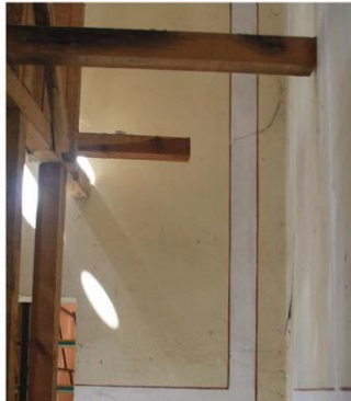
Imagen 3. Detalle de deterioro en yesería y dorado.
