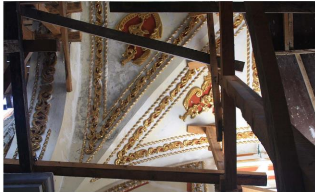
Imagen 4. Humedad por filtración es esquina este izquierda de la bóveda de crucería del ábside.
