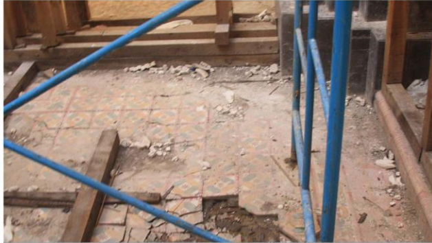
Imagen 1. Detalle de piso en zona de crucero, hundimiento a causa de colapso de cúpula en sismo de 2017.
