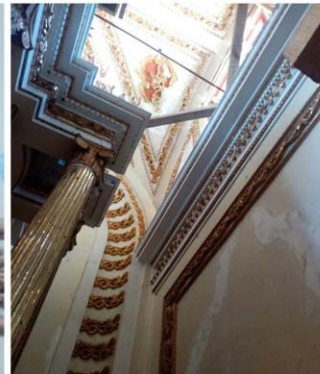
Imagen 4. Deterioro y desprendimiento de pintura.
