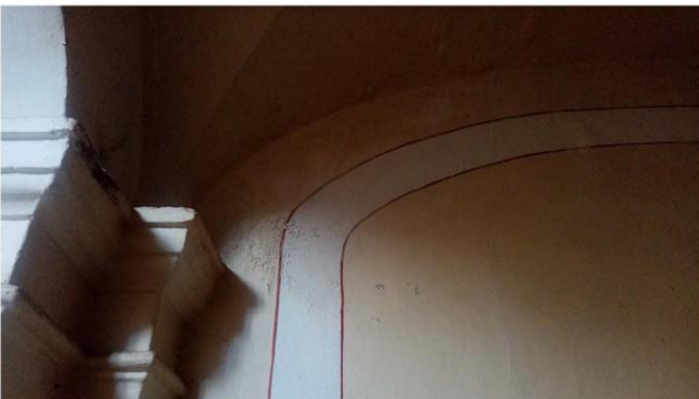
Imagen 3. Detalle de humedad sobre capital de pilastra del lado izquierdo de muro norte de sotocoro.
