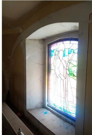
Imagen 2. Detalle resanes en muro este coro.
