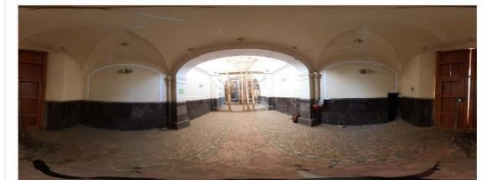
Imagen 1. Esférica de sotocoro en la que se aprecia el estado actual de la bóveda de lunetos.
