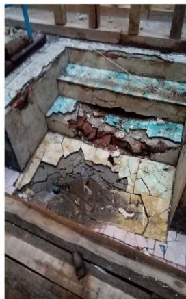
Imagen 3. Detalle de ruptura y hundimiento de escalones.
