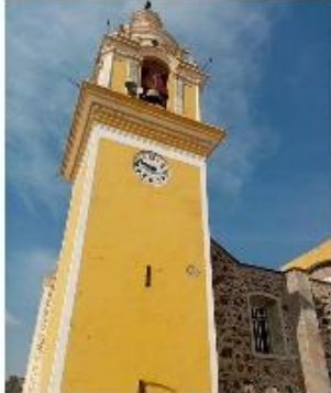
Imagen 1. Desprendimiento de pintura y de aplanado en torre
