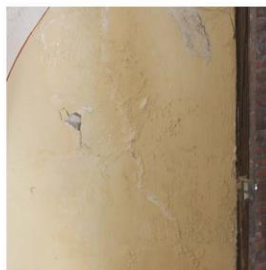
Imagen 3. Desprendimiento de aplanado.
