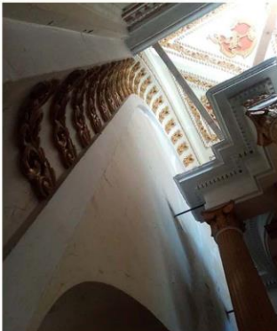
Imagen 4. Deterioro y suciedad de pintura en muro del ábside.
