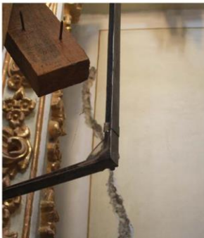
Imagen 2. Grieta en trancpto sur.
