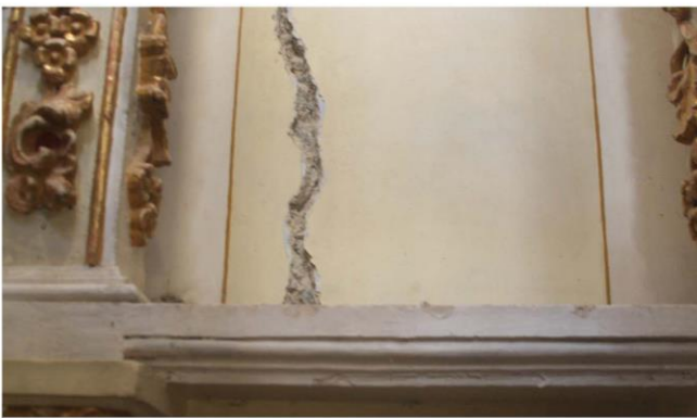
Imagen 4. Fotografía de fisura en muro en la que también se puede apreciar el despostillamiento de cornisa.
