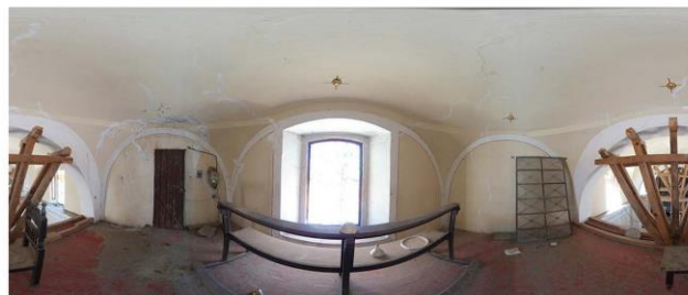
Imagen 3. Deterioros en cúpula oval, desprendimiento de pintura en muro colindante con torre campanario.
