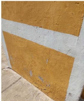
Imagen 4. Detalle de desprendimiento de pintura.
