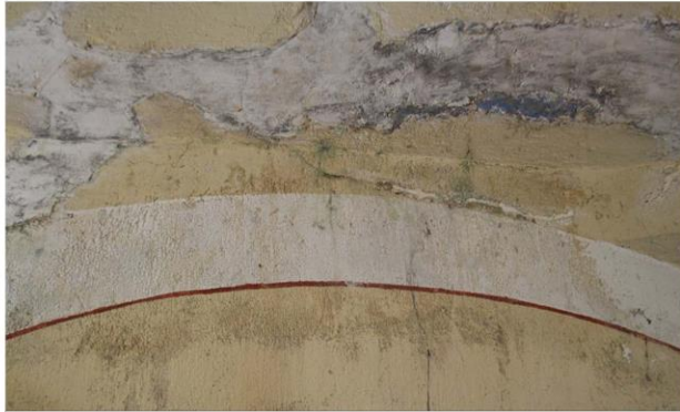
Imagen 1. Detalle de humedad en muro, deterioro de pintura y suciedad general en parte superior del muro norte.
