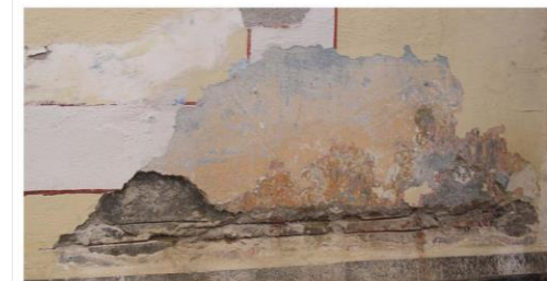
Imagen 5. Detalle de desprendimiento de aplanado que deja al descubierto el muro de mampostería.
