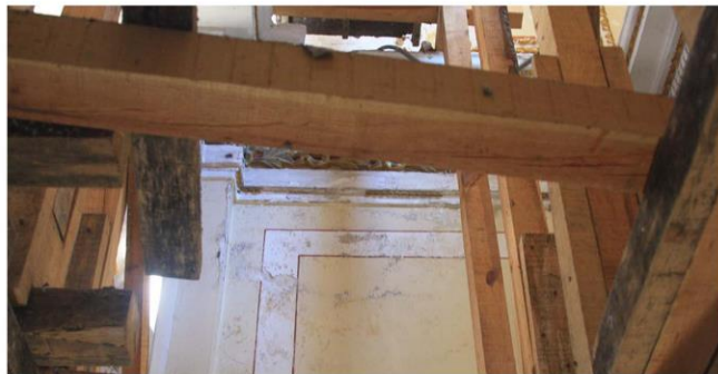
Imagen 5. Desprendimiento de yesería y dorado y desprendimiento de pintura.
