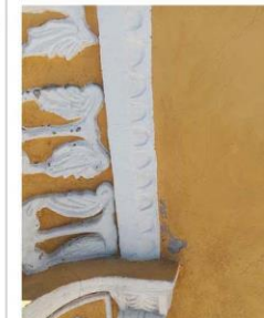
Imagen 5. Detalle de desprendimiento de pintura.
