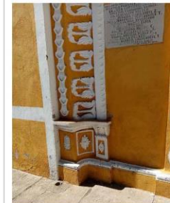
Imagen 3. Detalle de desprendimiento de pintura.
