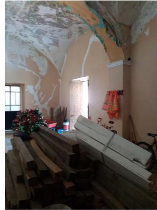
Imagen 2. Desprendimiento de aplanado en intradós de arco.
