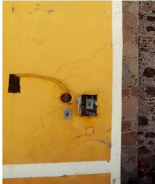
Imagen 1. Instalación eléctrica a un costado de torre campanario.
