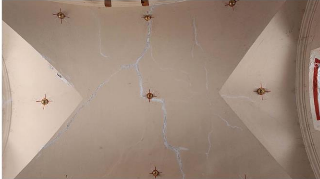
Imagen 1. Bóveda de crucería con suciedad y policromía en pintura en el primer tramo de la nave.
