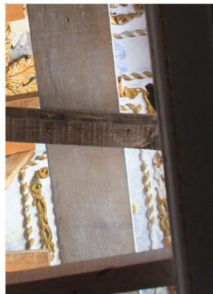
Imagen 3. Pérdida de yesería y dorado por humedades.
