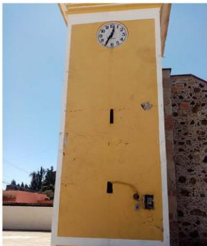
Imagen 3. Instalación eléctrica a un costado de torre campanario.
