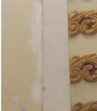
Imagen 2. Detalle desprendimiento de pintura.
