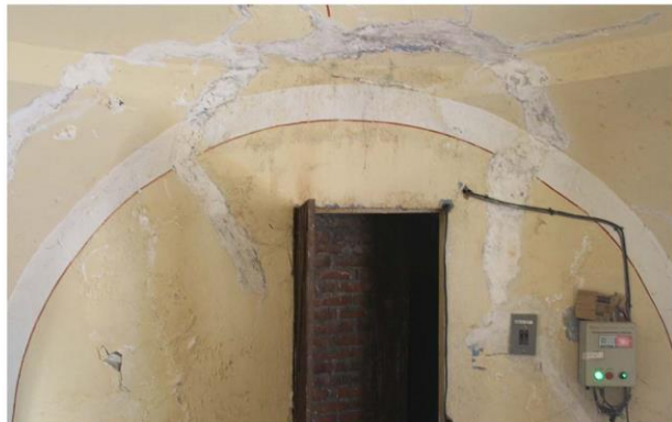
Imagen 2. Detalle de humedad en muro, inicio de desprendimiento de aplanados.
