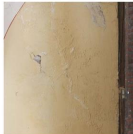
Imagen 3. Desprendimiento de aplanado.
