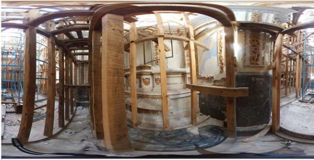
Imagen 1. Esférica de transepto sur en donde se aprecia la fisura en el muro oeste.
