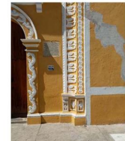
Imagen 5. Detalle de desprendimiento de pintura en torre-campanario.
