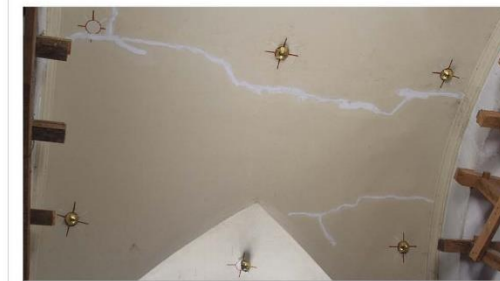
Imagen 4. Fotografía de bóveda de lunetos donde se notan los resanes.
