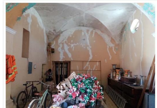
Imagen 1. Muro sur de sacristía que tiene puerta comunicando al ábside, se pueden ver resanes en todo el muro.
