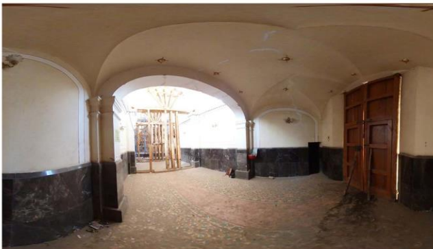
Imagen 3. Esférica de sotocoro en donde se aprecia la suciedad en el muro este en la cara interior.
