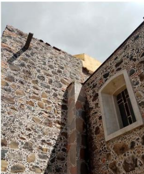
Imagen 3. Humedad en pilastra sobre vano tapiado.
