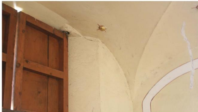
Imagen 2. Detalle de derrame y muro este en donde se aprecia la suciedad en pintura.
