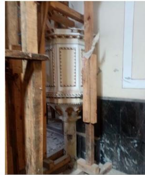
Imagen 4. Detalle de ruptura de elemento.
