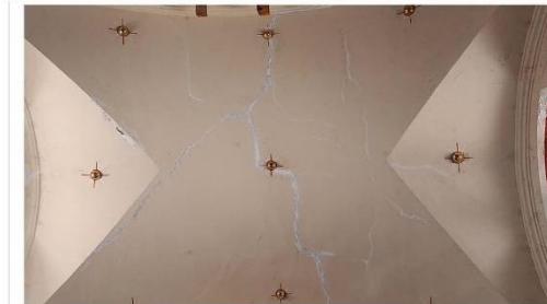
Imagen 1. Bóveda de lunetos en donde se aprecian los resanes realizados en las fisuras.
