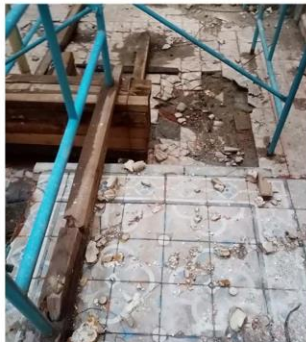
Imagen 4. Detalle de piso de pasta formato 20x20 roto.
