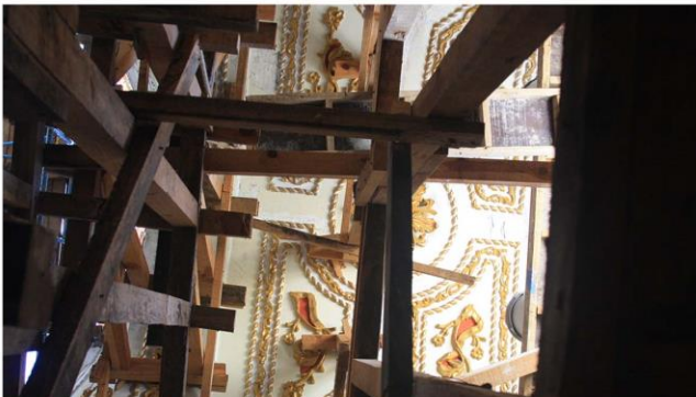
Imagen 2. Bóveda de lunetos con pérdida de piezas ornamentales de dorado y yesería.
