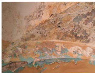
Imagen 3. Desprendimiento de pintura por humedades.
