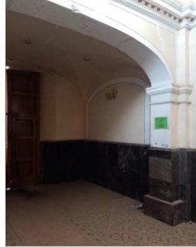
Imagen 2. Muro sur de sotocoro con suciedad en pintura
