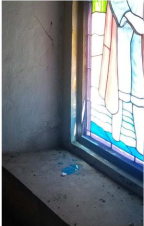
Imagen 1. Detalle resanes en muro este coro.
