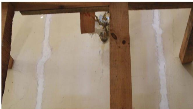
Imagen 4. Se observe suciedad general en pintura de muro norte de trancpto norte.
