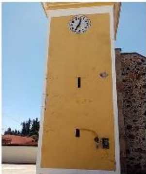
Imagen 3. Desprendimiento y craquelado de pintura
