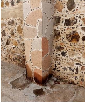
Imagen 1. Humedad por capilaridad en pilastra.
