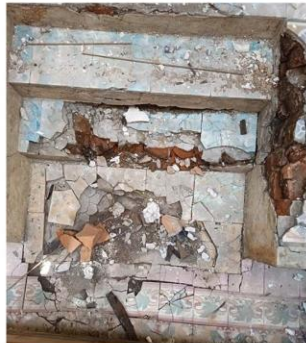
Imagen 2. Detalle de escalones a ábside rotos.
