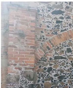
Imagen 3. Degradación de ladrillo en pilastra.
