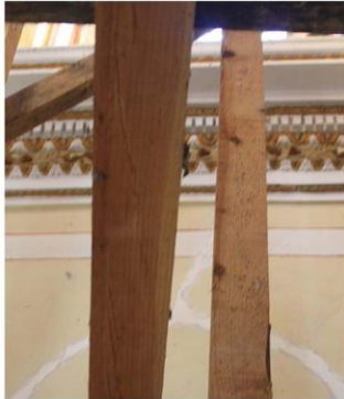
Imagen 2. Deterioros en pintura por mezcla.
