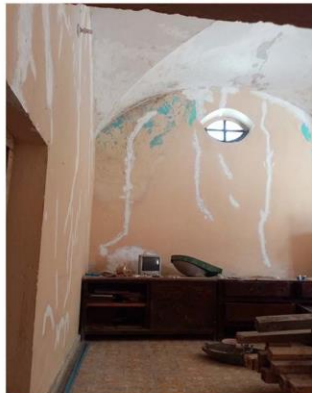
Imagen 2. Humedad por filtración en muro de sacristía.
