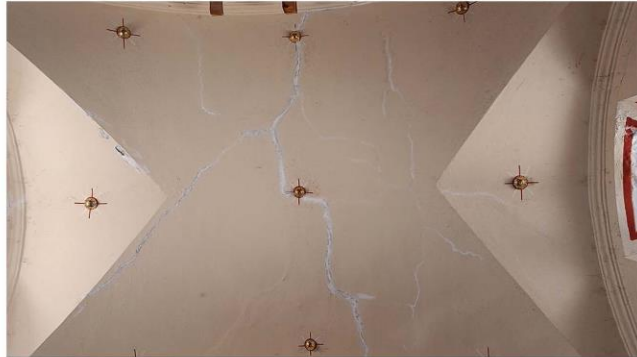
Imagen 1. Bóveda de lunetos en donde se aprecian los resanes realizados en las fisuras.
