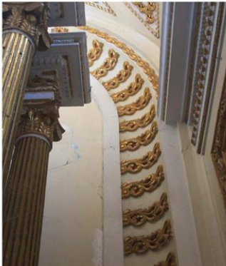
Imagen 3. Detalle de deterioro y desprendimiento de pintura.
