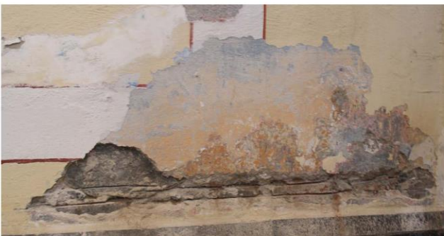
Imagen 5. Detalle de desprendimiento de aplanado que deja al descubierto el muro de mampostería.
