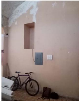
Imagen 3. Humedad por filtración en muro de sacristía.
