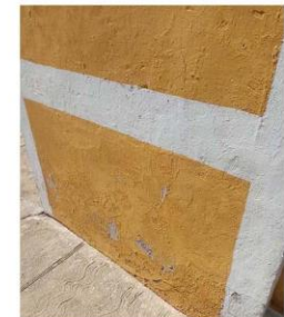
Imagen 4. Detalle de desprendimiento de pintura.
