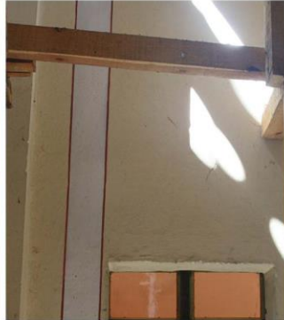
Imagen 2. Detalle desprendimiento de pintura.
