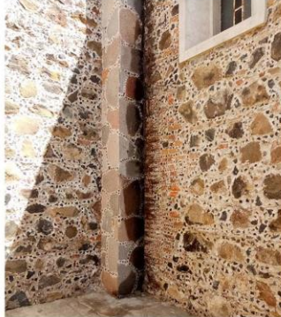
Imagen 2. Humedad en pilastra y unión del muro.
