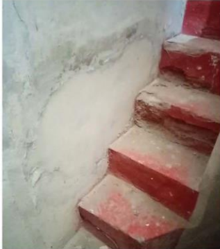
Imagen 1. Humedad por capilaridad en parte inferior del muro.
