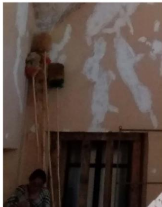
Imagen 3. Humedad por filtración en muro de sacristía.
