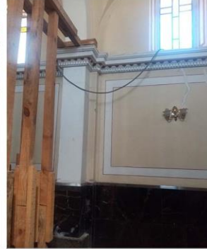
Imagen 2. Detalle de suciedad en pintura.
