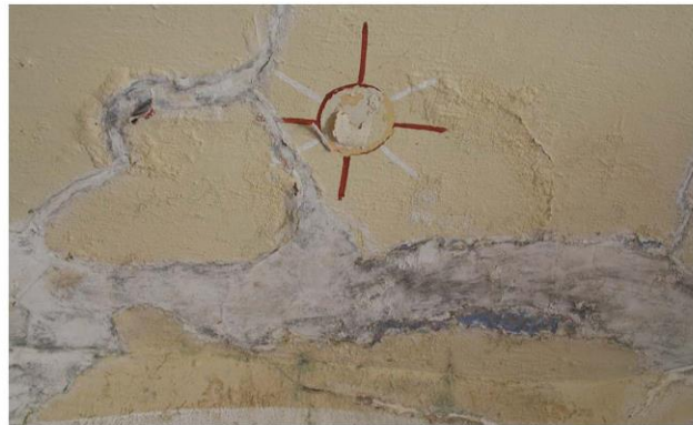
Imagen 2. Deterioro de pintura y humedad en cúpula oval.
