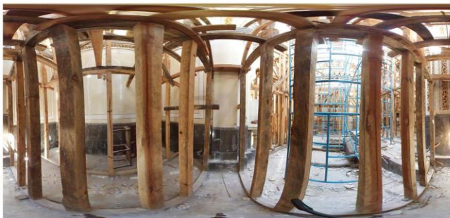
Imagen 4. Suciedad general en el transepto norte en donde se presentan rayones en pintura de muros.
