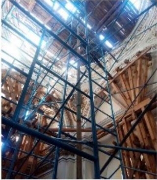
Imagen 1. Faltante de cúpula en crucero.
