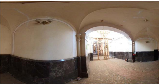
Imagen 3. Esférica de sotocoro en donde se aprecia la suciedad en el muro sur en la cara interior.
