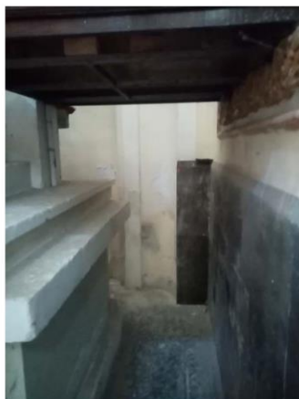
Imagen 2. Detalle de parte trcera de ábside con piso con polvo.
