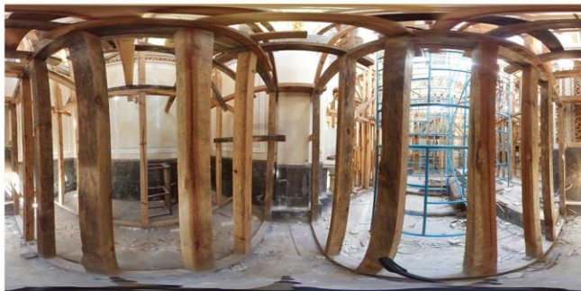
Imagen 2. Suciedad, mure, basura y escombros en piso de transepto norte.
