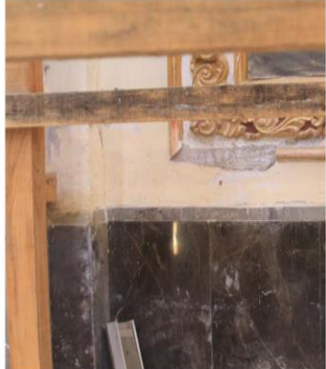
Imagen 1. Detalle de faltante de marco de yesería y dorado.
