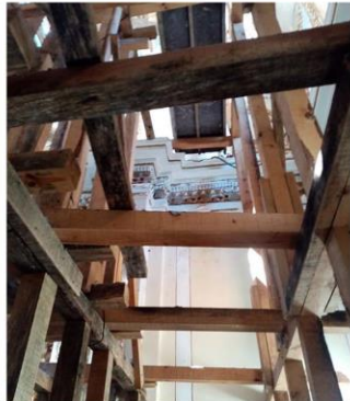
Imagen 4. Deterioro y desprendimiento de pintura.
