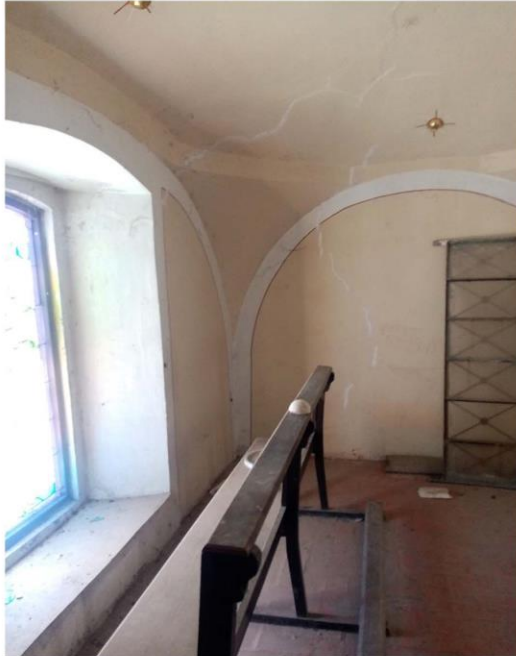
Imagen 1. Detalle de muro sur de coro en el que se aprecian deterioros en pintura.
