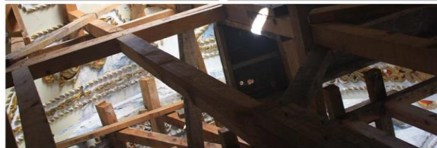
Imagen 5. Desprendimiento de yesería y dorado causado por humedades en la bóveda de lunetos.
