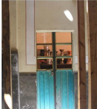
Imagen 1. Desprendimiento de pintura,
