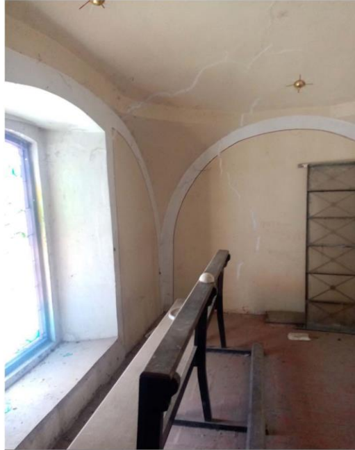
Imagen 1. Detalle de resane en muro sur de coro.
