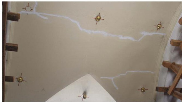
Imagen 4. Fotografía de bóveda de lunetos donde se notan los resanes.
