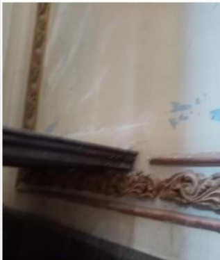
Imagen 3. Detalle de deterioro en yesería y dorado.
