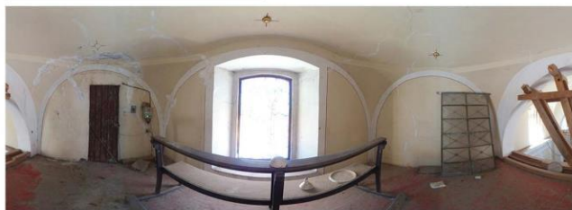
Imagen 3. Desprendimiento de pintura por humedades.
