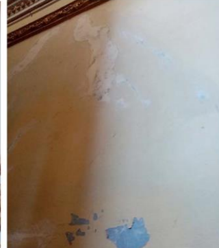
Imagen 2. Detalle desprendimiento de pintura.
