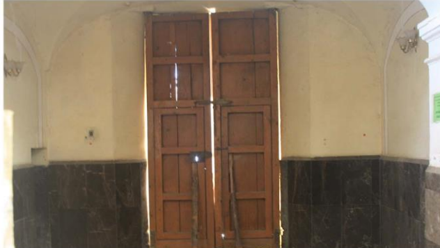
Imagen 1. Vista de muro este interior en sotocoro en acceso principal se aprecia la suciedad en la pintura y deterioros en puerta.
