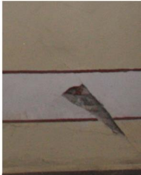
Imagen 2. Detalle de desprendimiento de aplanado.
