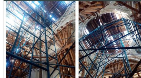
Imagen 1. Faltante de cúpula en crucero.
