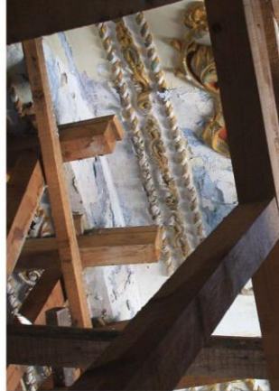
Imagen 2. Humedades en arco y bóveda de lunetos.
