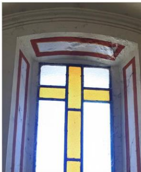
Imagen 4. Detalle de humedad en derrame de ventana.
