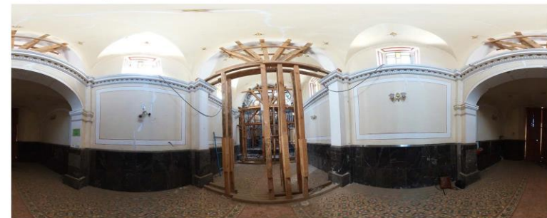
2. Fotografía esférica del primer tramo de la nave, este espacio antecede al segundo tramo de la nave, está limitada a los lados por dos muros y cubierta por una bóveda de lunetos. Fotografía: Ana Vanesa Mejía. Noviembre 2022
