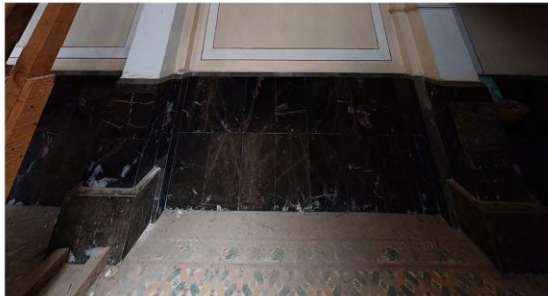
Imagen 2. Primer tramo de la nave, piso cubierto por polvo y suciedad.
