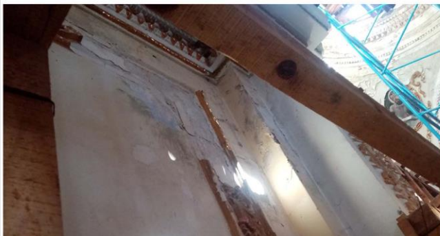
Imagen 5. Desprendimiento de yesería y dorado y desprendimiento de pintura.
