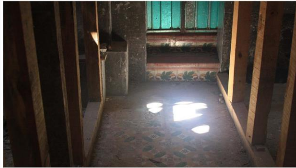
Imagen 1. Suciedad y mugre en piso del transepto norte.
