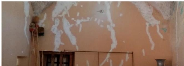
Imagen 5. Humedades por filtración en esquinas de muro sur de sacristía.
