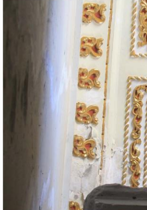
Imagen 2. Humedad en esquina oeste de bóveda.
