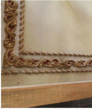
Imagen 1. Detalle de deterioro de pintura en muro este.
