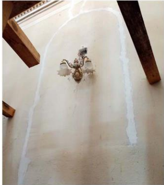
Imagen 1. Detalle de muro salpicado por mezcla.
