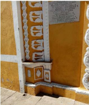
Imagen 3. Detalle de desprendimiento de pintura.
