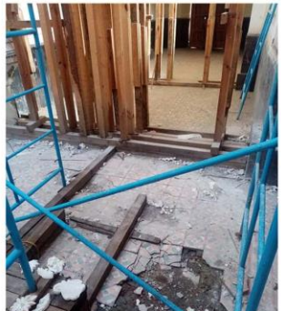
Imagen 5. Detalle de zona de piso roto en crucero.
