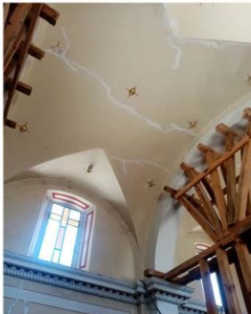
Imagen 2. Segundo tramo de la nave desprendimiento de decoración.
