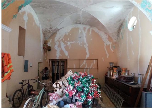
Imagen 1. Muro sur de sacristía que tiene puerta comunicando al ábside, se pueden ver ligeras humedades en las esquinas superiores del muro.
