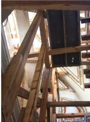
Imagen 1. Desprendimiento de yesería y dorado.
