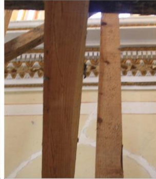
Imagen 2. Resane en muro de transepto norte.
