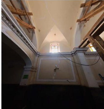
Imagen 1. Primer tramo de nave se observa detalle de desprendimiento.
