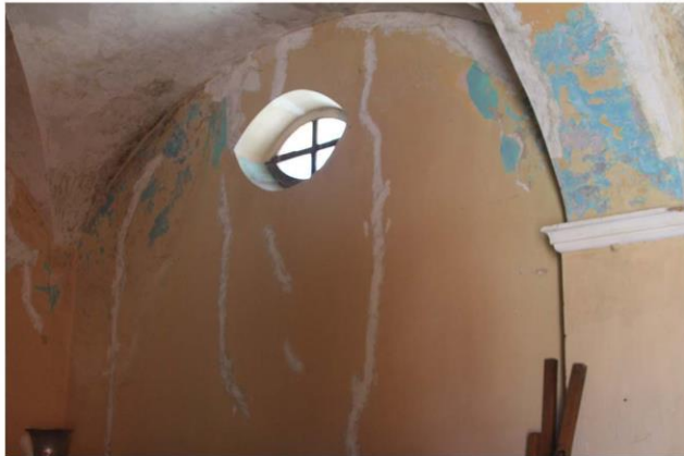
Imagen 1. Muro soeste de sacristía con humedades en unión de bóveda de crucería con muro.
