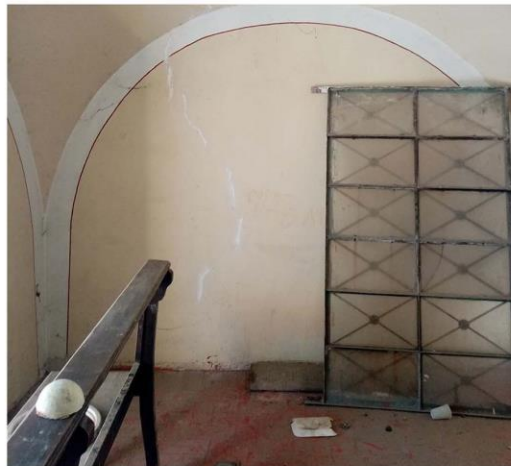
Imagen 2. Deterioros de pintura y suciedad en muro sur del coro.
