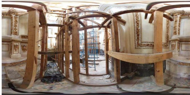
Imagen 1. Esférica de trancpto sur en donde de aprecia la suciedad general por polvo y mugre así como los deterioros.
