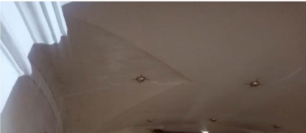
Imagen 3. Detalle de humedad en sección de bóveda de sotocoro.
