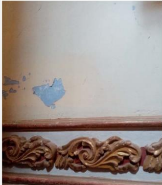
Imagen 1. Desprendimiento de pintura,
