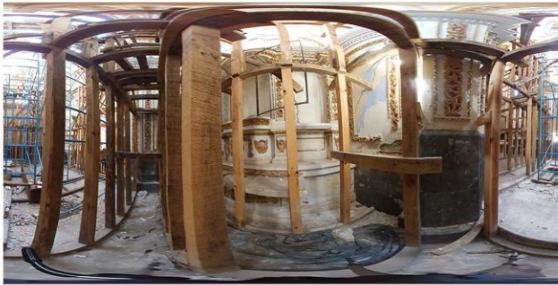
Imagen 1. Esférica de trancpto sur en donde de aprecia la fisura en el muro oeste.
