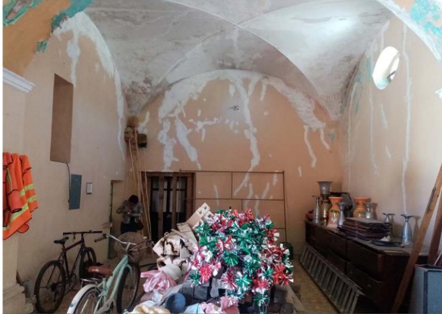
Imagen 1. Muro sur de sacristía que tiene puerta comunicando al ábside, se pueden ver resanes en todo el muro.
