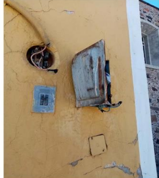
Imagen 2. Instalación eléctrica a un costado de torre campanario.
