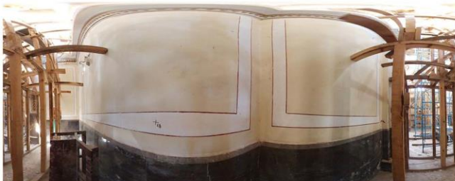
Imagen 3. Suciedad y mugre en lambrín de mármol Santo Tomás así como suciedad presente en el muro este del transepto.
