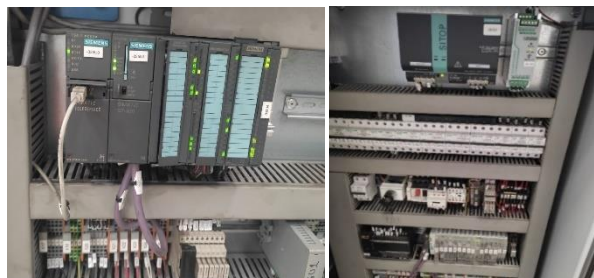
Figura 32: Tablero de control
