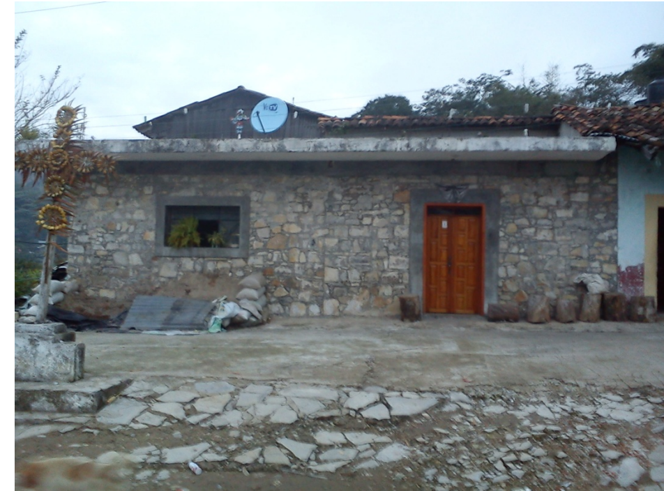
Imagen 16. Ejemplo de casa hecha a base de piedra en combinación con sistema de losa prefabricada. Fotografía tomada por el autor.
